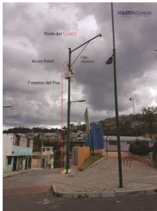
Ejemplo de cómo se realizó Instalación de puntos en Poste del Ecu911 en parque de la Bota.
