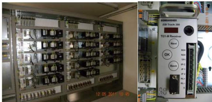
Figura 7 Elementos de cabina de los circuitos de vía TI21-M
