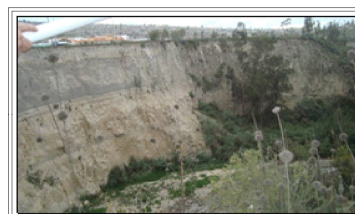
Fotografía. Talud de más de 60 metros de altura, casi vertical, formado por la acción hídrica en la margen derecha del Río Monjas. Fenómenos de remoción en masa.(Derrumbes, caídas de bloques, deslizamientos) que a corto, mediano o largo plazo, afectarían la vía en construcción.
