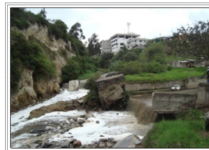
Fotografía. Desembocadura del Colector Parcayacu de aguas servidas y de escorrentía en la Quebrada El Colegio. Estructura semidestruida por la acción hídrica (Erosión y socavación).
