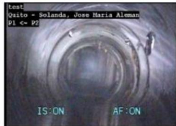
Foto: 1_6A 30m, Fractura longitudinal, en 09 en punto, within 200mm of joint: NO, Acabado / Se recomienda la reparación total del tramo.
