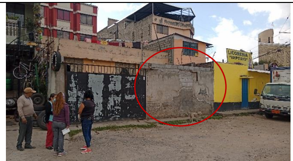
Foto 7.1.8 Predio 318961 con fisuras y grietas en cerramiento, aparentemente causadas por el choque de un tráiler.
