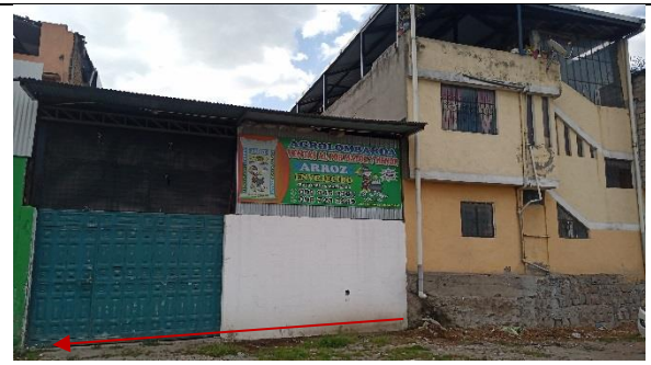
Foto 7.1.6. Predio 318509 con aparente asentamiento del suelo.
