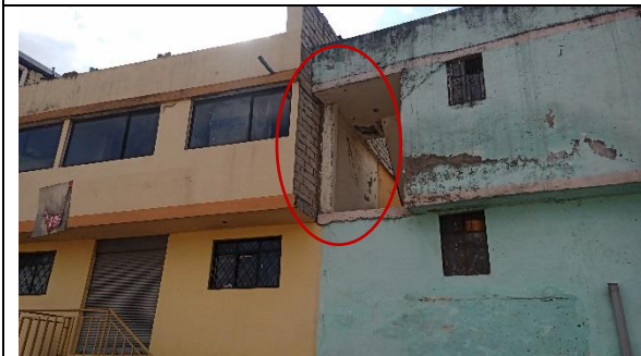
Foto 7.1.7. Predio 318506 con fisuras y grietas en columnas.
