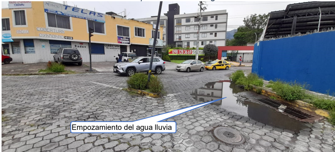
FOTO 7: “Hundimiento de la vía”
