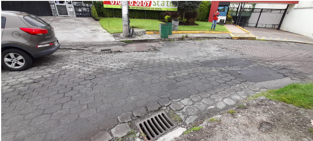
FOTO 4: “Hundimiento de la calzada”
