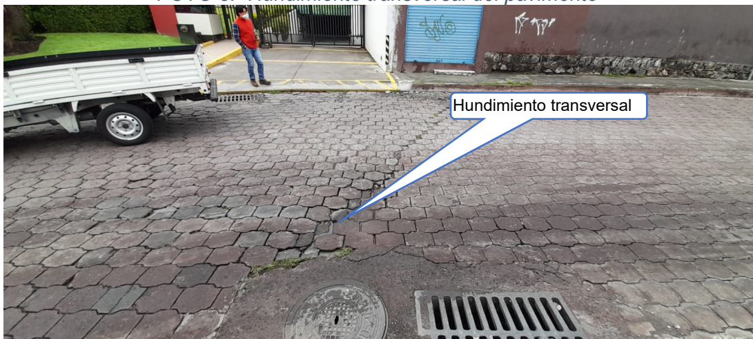
FOTO 5: “Hundimiento transversal del pavimento”
