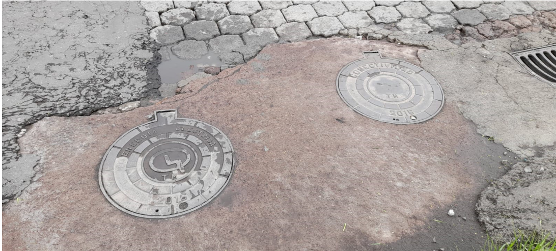
FOTO 9: “Pozos en la calzada”
