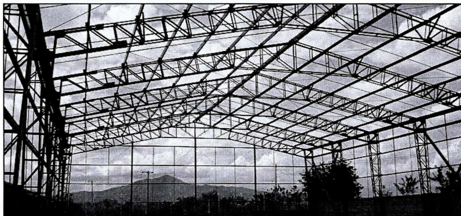
Imagen referencial de una edificación con estructura de cercha metálica Fuente: http://www.institutoimatec.cl/construcciones-metalicas-e-interpretacion-de-planos/
