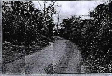
FIGURA No. 3 Capa de Rodadura Sub rasante expuesta.
