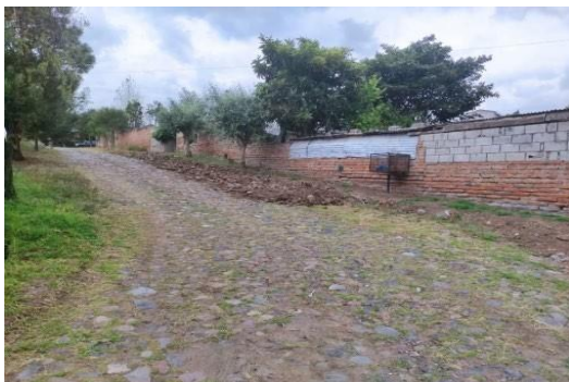
Fotografía 5 Calle A, no presenta bordillos
