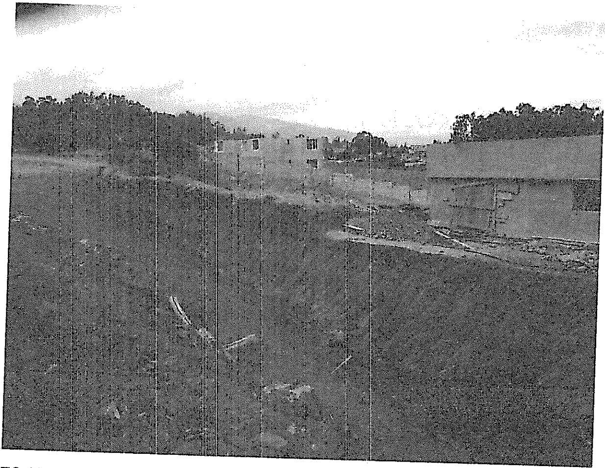
FOTO 18. APERTURA DE CALLE SUR 12 METROS SEPARA IMPRENTA Y FAMILIA RÍOS, NIVELES DE LA VÍA Y CASA CONSTRUIDA
