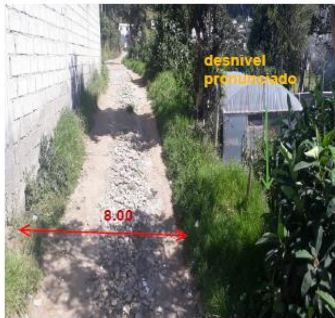
Fotografía 1: Callejón B, desnivel pronunciado
