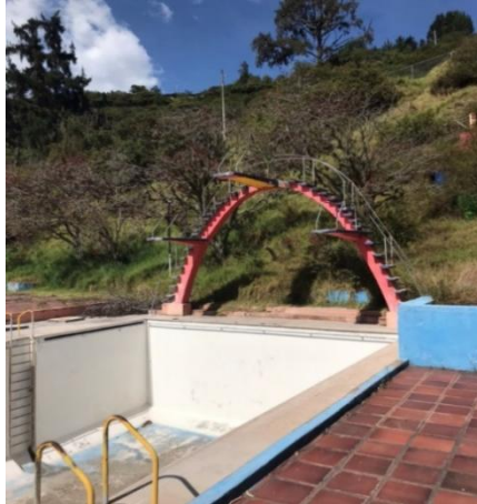
Foto 2: Instalaciones piscina olímpica
