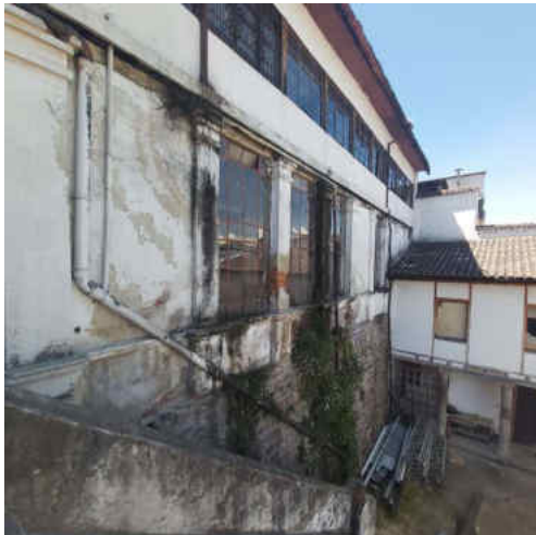
Bajantes en mal estado
