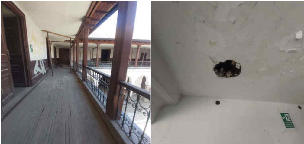
Cielo raso de malla fisurado y roto.
