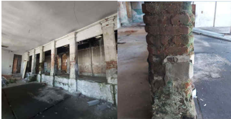
Área de la antigua imprenta, columnas de ladrillo erosionadas y húmedas
