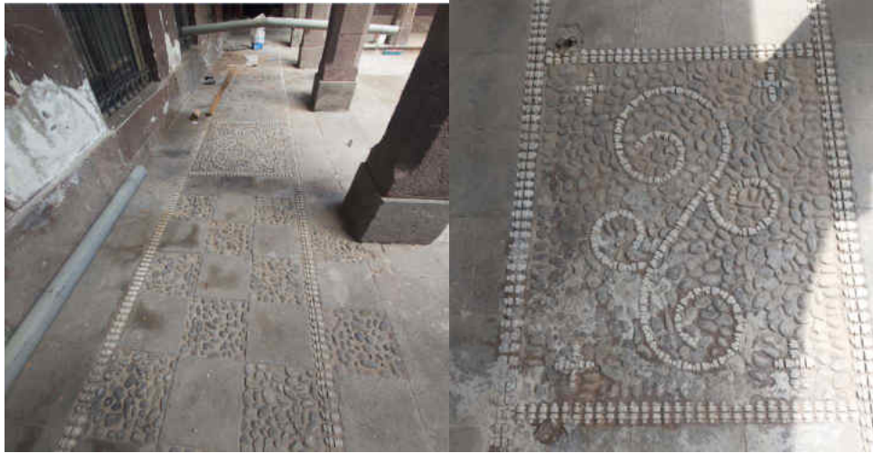
Suciedad por depósito en recubrimientos de piso
