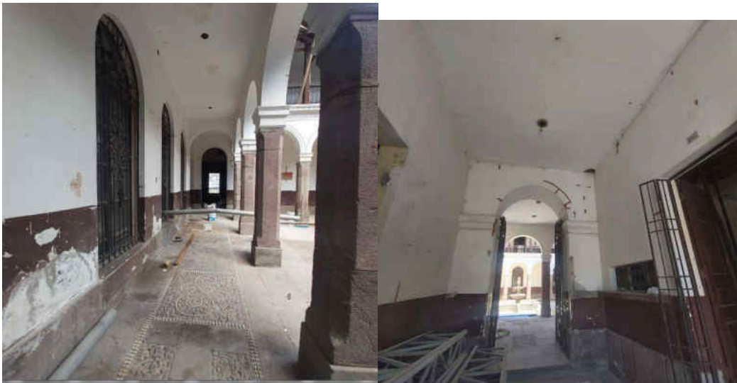
Cielo raso de malla enlucida presencia de fisuras y roturas
