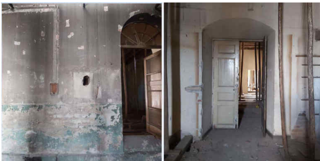
Suciedad por depósito en muros
