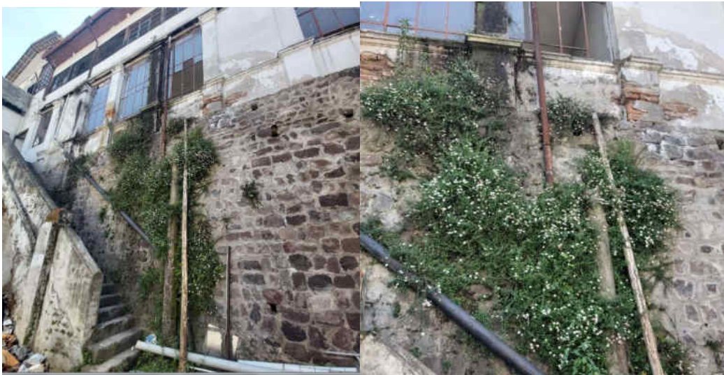
Presencia de humedad por filtración en muro de piedra.
