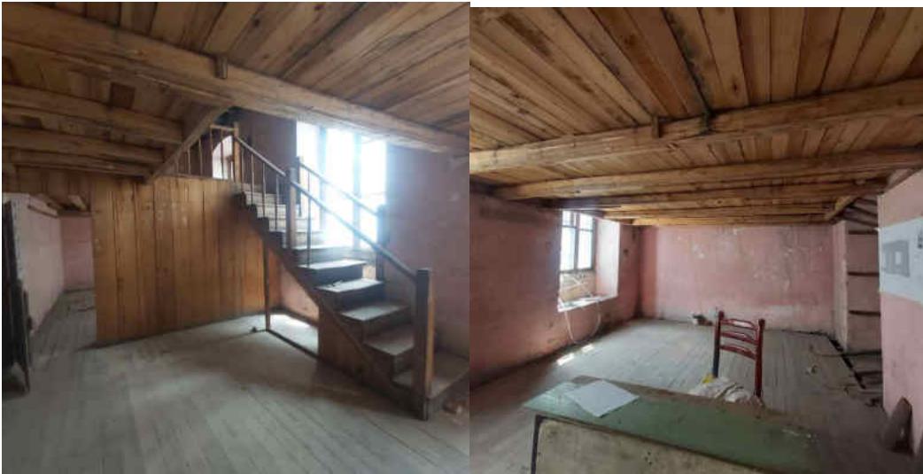
Presencia de entrepisos añadidos de madera.
