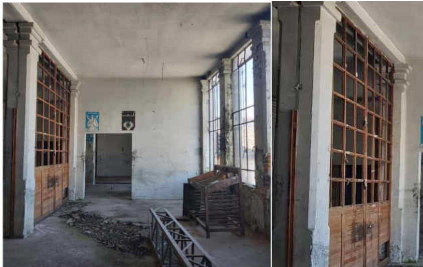
Mamparas de madera a restaurarse
