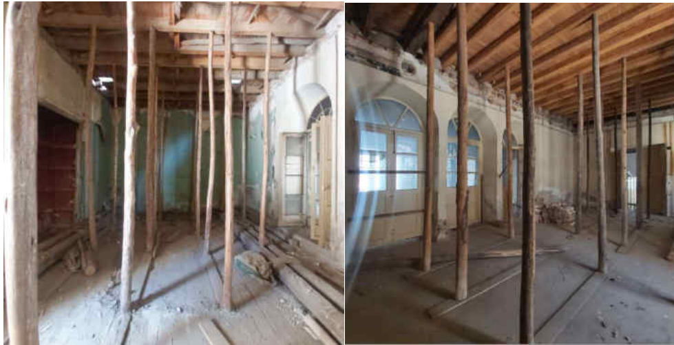
Entablado de pisos en mal estado
