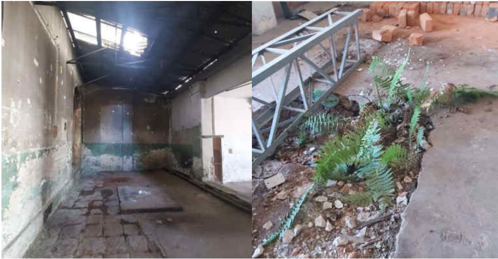
Área de la antigua imprenta, presencia de humedad en pisos
