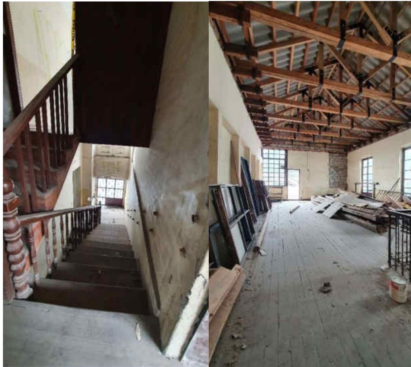
Izq: escaleras de servicio; Der: cuarto junto al balcón de planta alta
