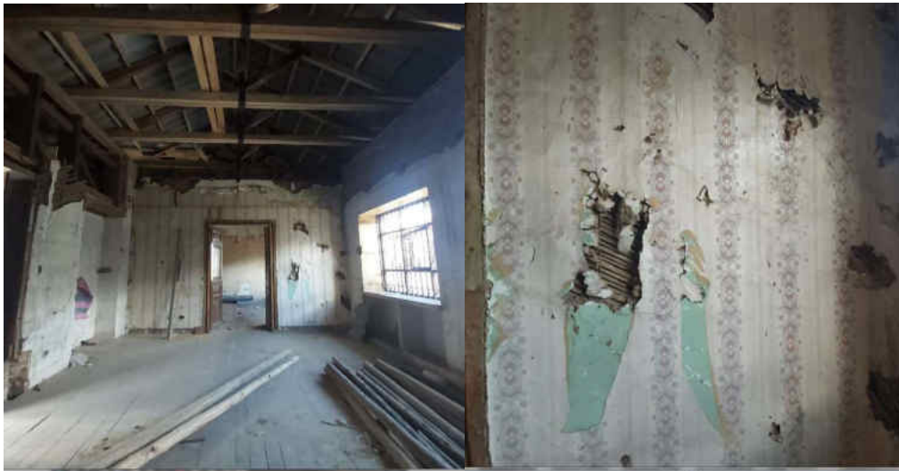
Tabiquería de bahareque en mal estado.
