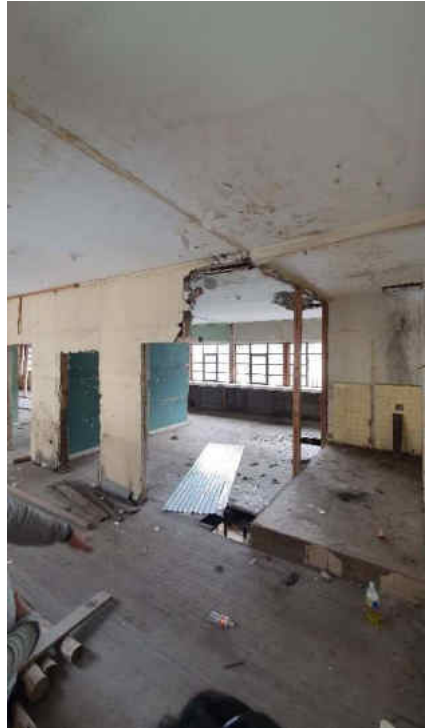
Fotografía entrepiso imprenta con perforaciones y mal estado
