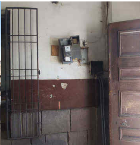
Instalaciones eléctricas sin funcionamiento
