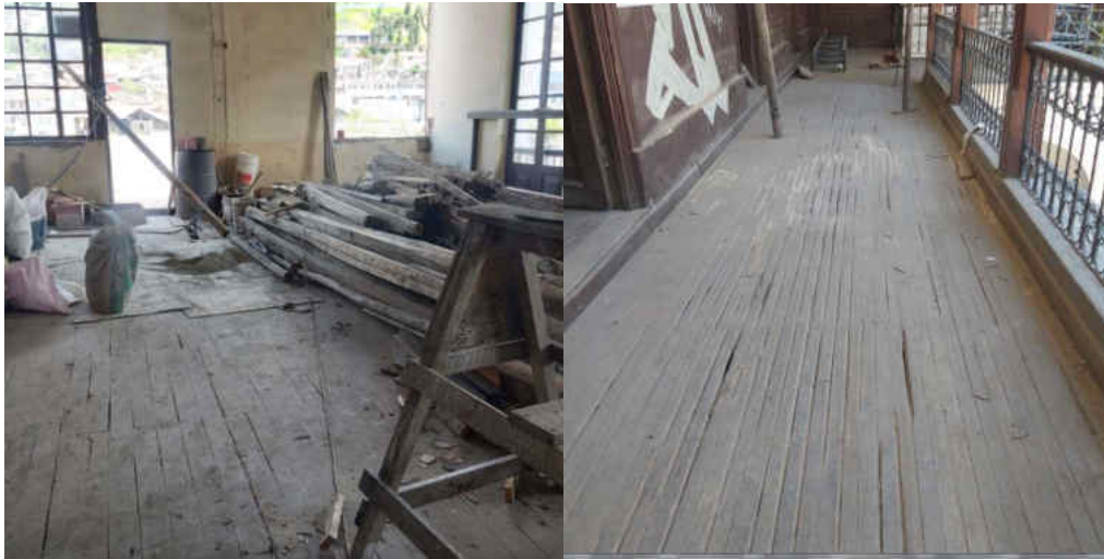
Entablado de madera en mal estado.
