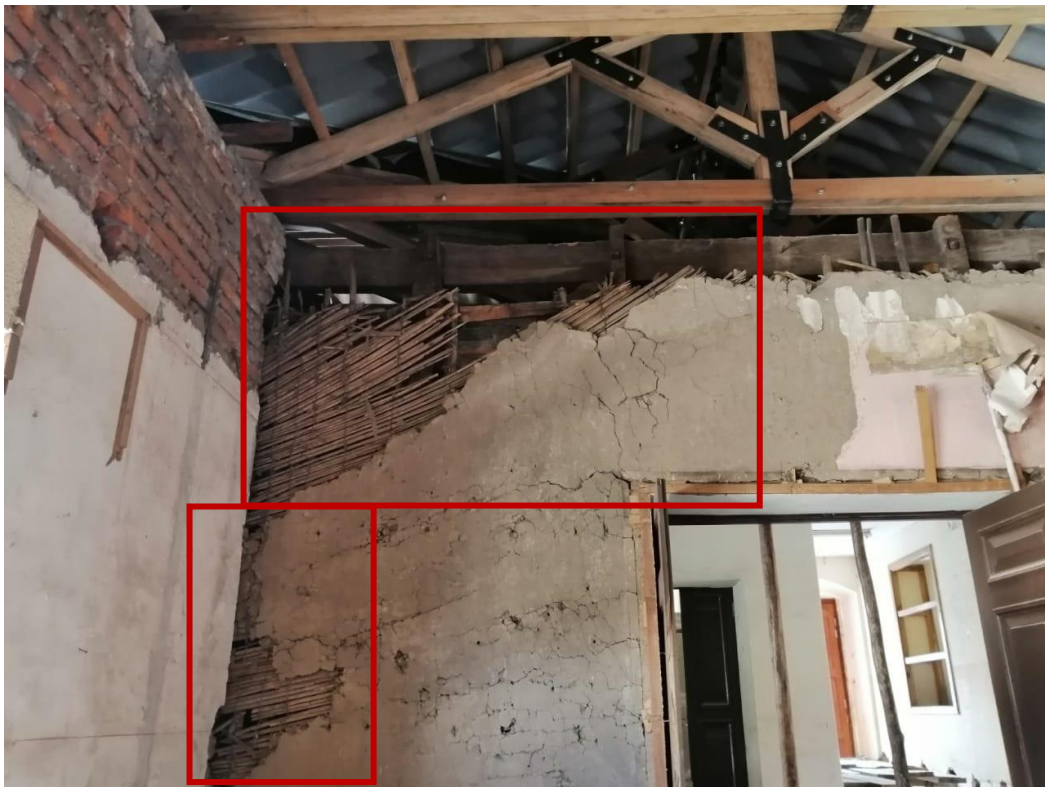
Figura 4. Carrizo expuesto a la intemperie
