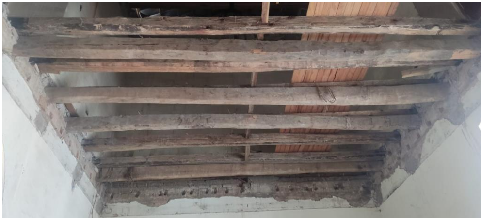
Figura 7. Fisuras en elementos vigas de madera
