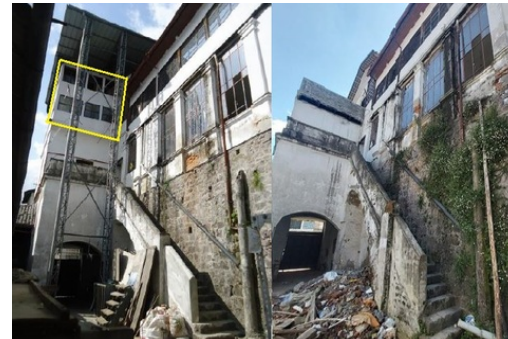
Descripción: Comparación de espacio posterior hacia la calle Guayaquil en donde se ha liberado una construcción añadida para adaptar una terraza abierta.
