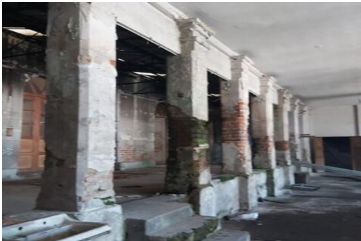
Descripción: Vista de columnas de ladrillo que presentan deterioro.
