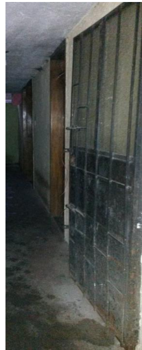
IMAGEN 06: Corrosión en puertas
