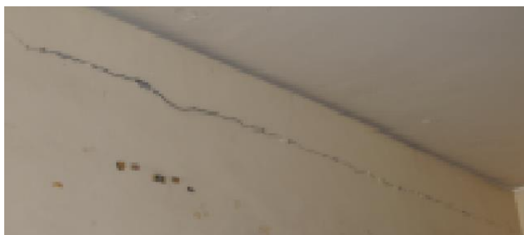
IMAGEN 01: Fisura sobre cierres horizontales
