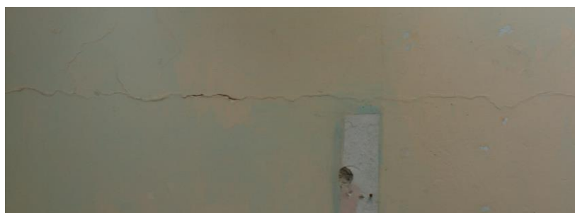
IMAGEN 02: Fisura sobre paredes
