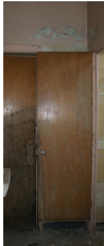
IMAGEN 12: Puerta en mal estado
