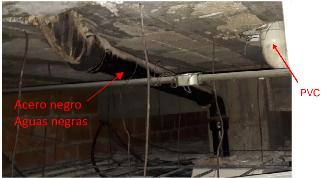
Figura 8. Instalaciones en Techo de Salón Sangay – 2
