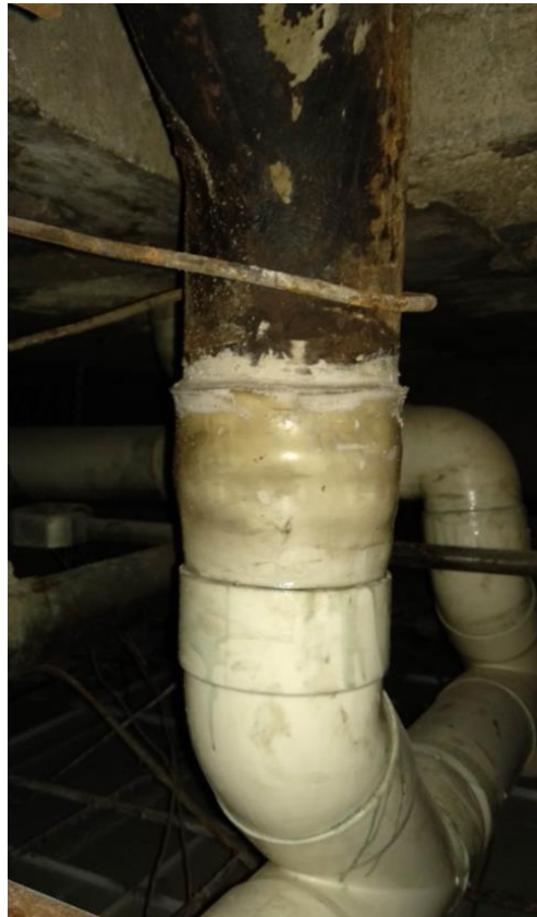
Figura 7. Instalaciones en Techo de Salón Sangay – 1
