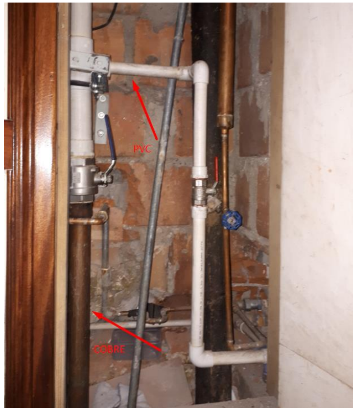
Figura 1. Gabinete de Ductos – Instalaciones – Agua
