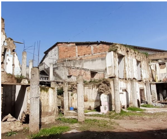
F_12 N+3.8 0 Crujía Posterior colapsada
