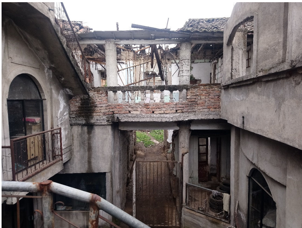
PATIO CENTRAL. SE EVIDENCIA LA AÑADIDURA DE ELEMENTOS DE HORMIGÓN, AFECTANDO LA TIPOLOGÍA ORIGINAL.
