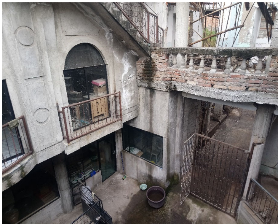
ACCESO A LA PARTE POSTERIOR DEL INMUEBLE. SE APRECIA LA ALTERACIÓN DE TIPOLOGÍA Y MORFOLOGÍA ORIGINALES.
