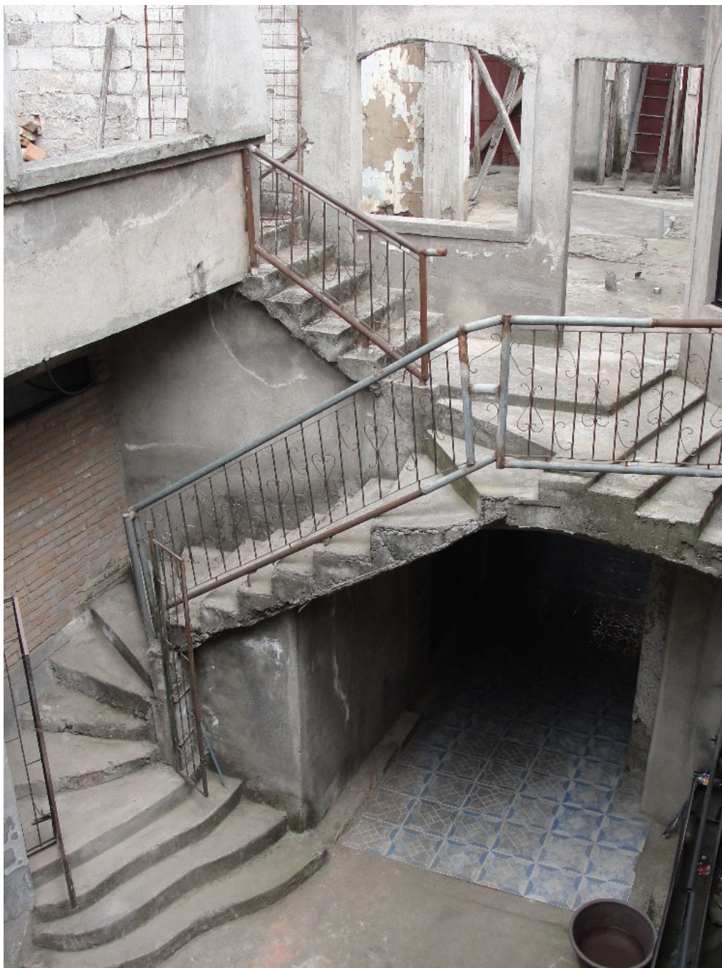
PATIO CENTRAL ALTERADO EN SU TIPOLOGÍA ORIGINAL.
