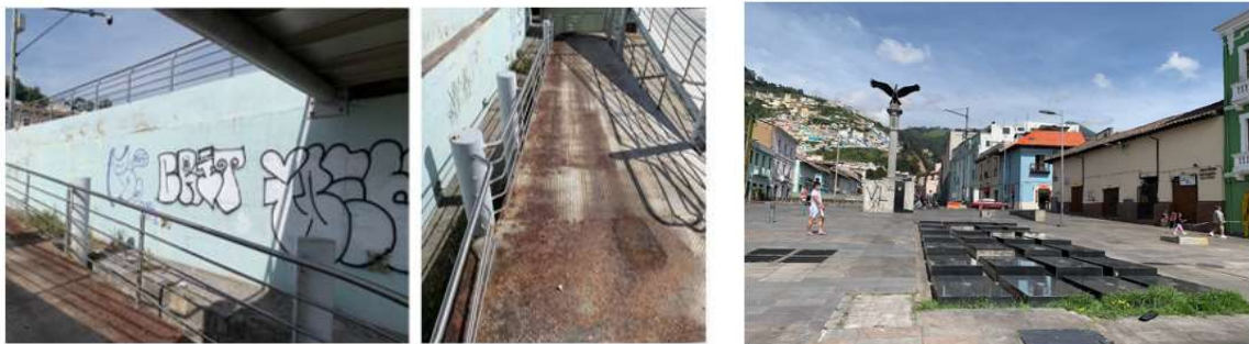
Figura 14. Rampas y elementos urbanos vandalizados. Boulevard 24 de Mayo Fuente: IMP
