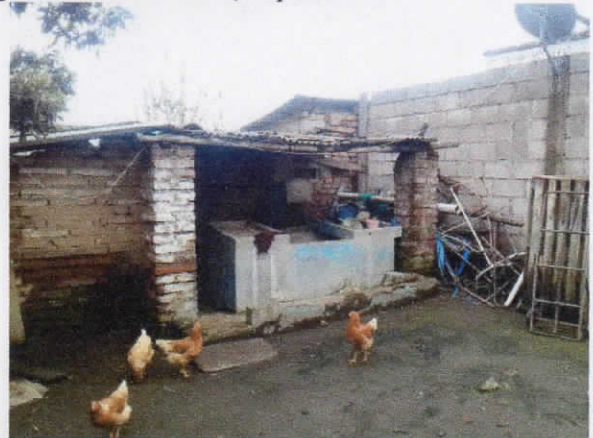
F.37 Espacio exterior añadido para batería sanitaria y área de lavado también a punto de colapsar
