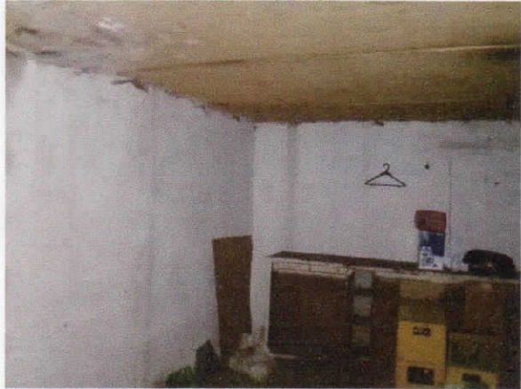
F.36 Espacios interiores sin funcionalidad, iluminación, Ventilación, ni instalaciones eléctricas
