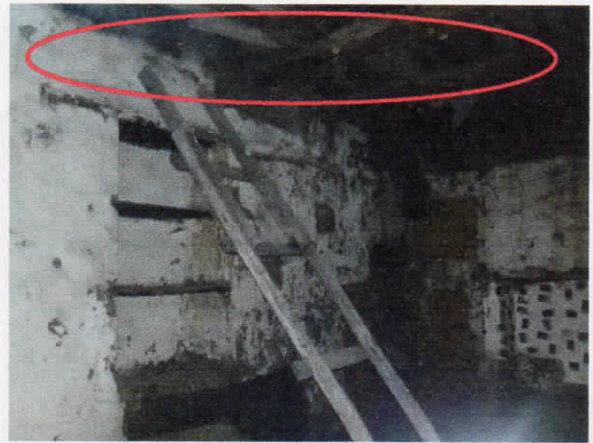
F.33 Estructura de cubierta inservible en todos sus elementos, Se considera que hubo cielos rasos, pero ya no existe
