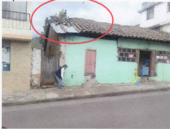
F.34 Cubierta de la edificación deteriorada a punto del colapso Riesgo eminente para peatones y propietarios
