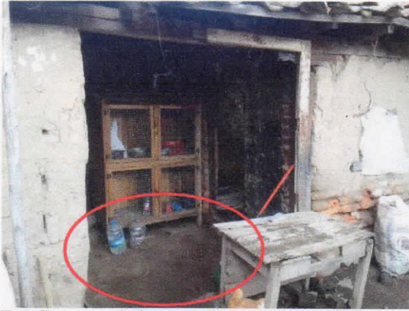
F.32 Contrapios de tierra con alto grado de humedad y Desprendimiento
