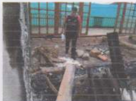
Estructura de piso y elementos de cubierta quemados
