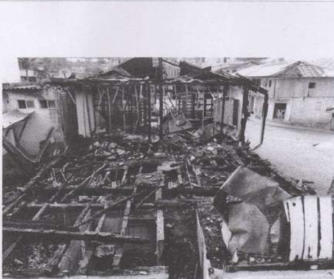
FOTOGRAFÍA N°6 : INDICIOS ENCONTRADOS - EFECTOS PERLA POR CORTOCIRCUITOS
