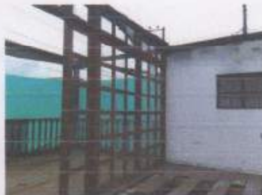
Afectación de estructuras de madera
