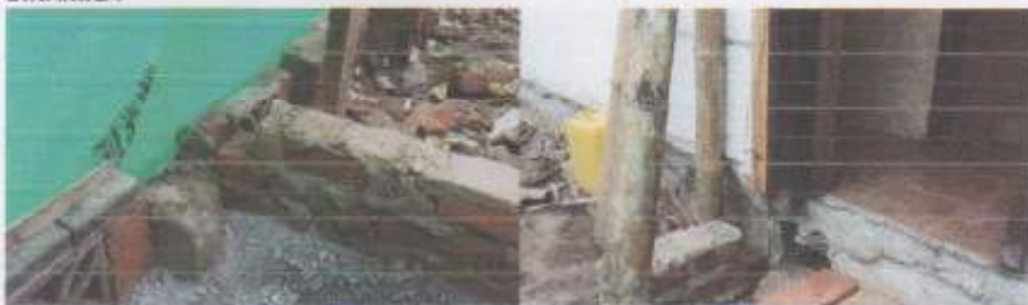
CIMENTACIÓN - FALTA DE TRABE
