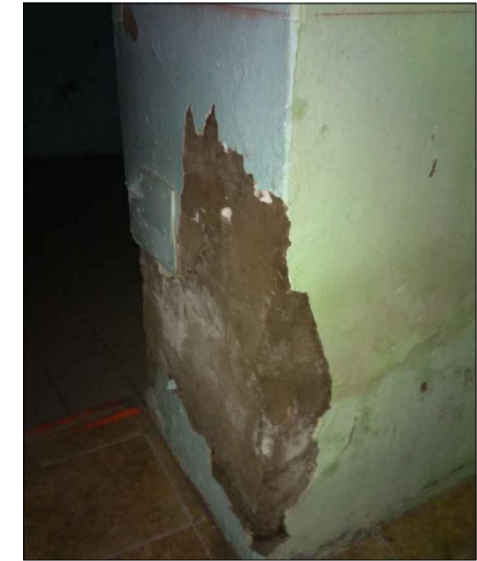
2. DESPRENDIMIENTO DE ENLUCIDO - HUMEDAD
