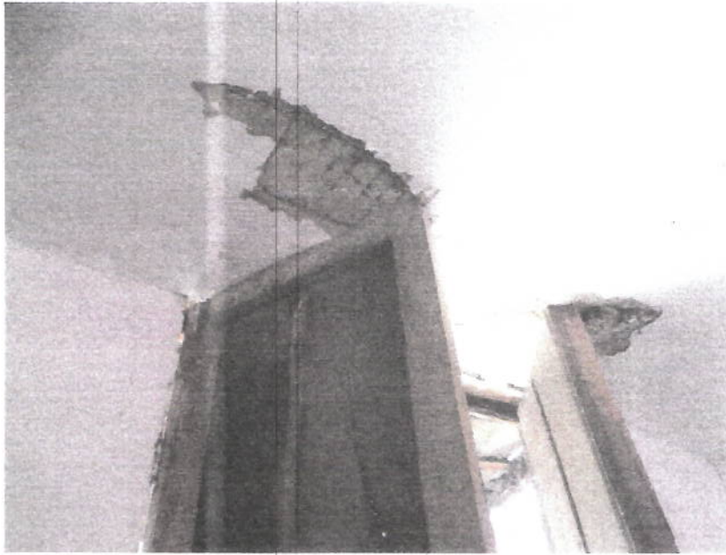
Puertas remordidas por la presión del peso del tejado
