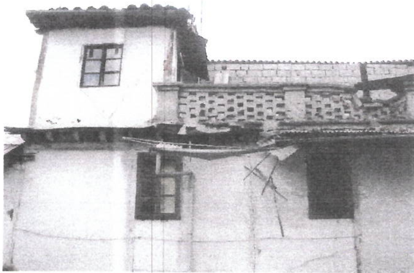
Ultima planta de la edificación de tres pisos, compuesta por una losa catalana y una pequeña habitación.
