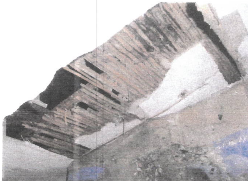
Cielo raso de carrizo y lodo en mal estado
