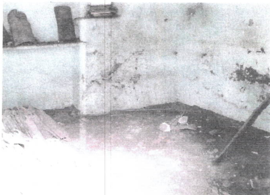
Piso de tierra, paredes húmedas
