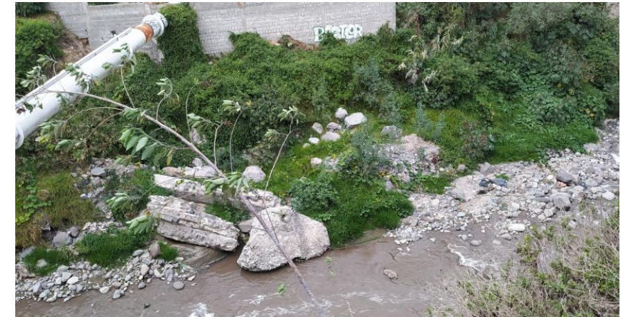
Foto No. 4: Muros colapsados en cauce.
