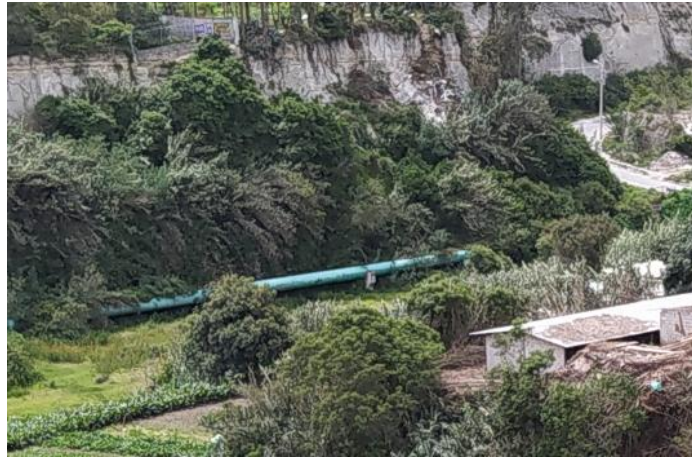
Foto No. 2 Tubería sub aérea de aguas servidas ( se encuentra en zona de inundación)
