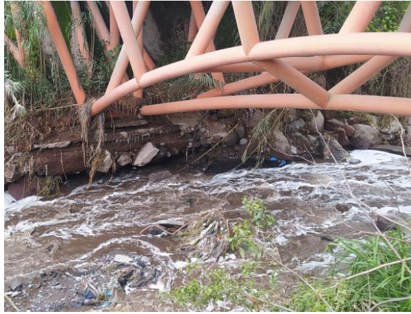
Foto No. 1: Socavación en base de puente, margen derecha.
