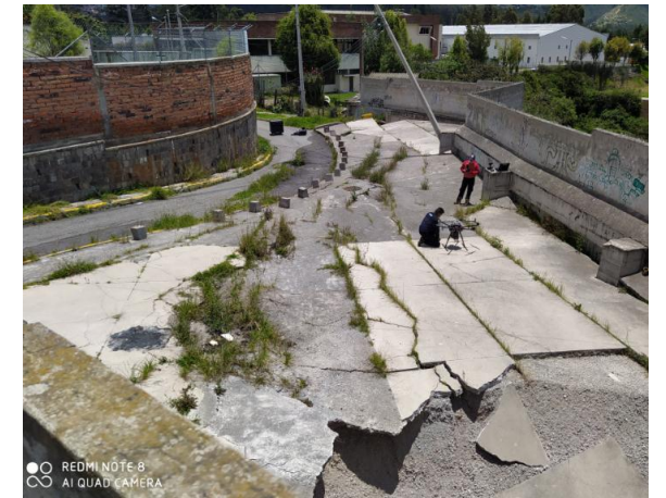
Foto No. 3: Asentamiento de la mesa de la vía y fuga de material de relleno.
