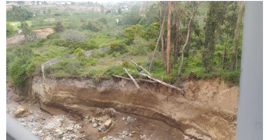
Foto No. 4: Árboles al borde superior de talud., por caer generan inestabilidad talud.
