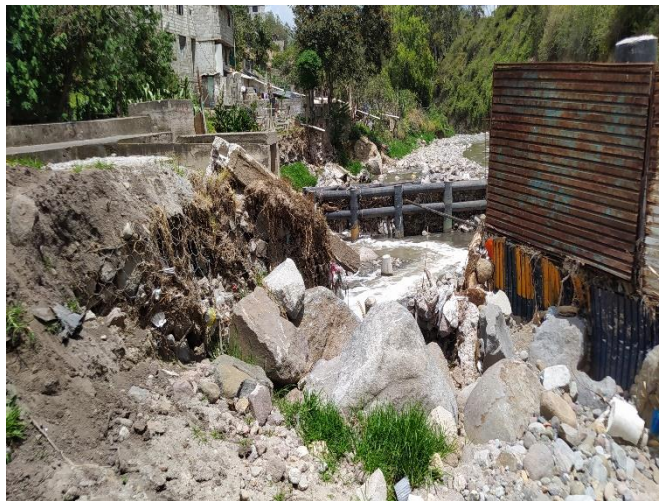
Foto No. 2: Elementos estructurales EPMAPS de muros colapsados en cauce.
