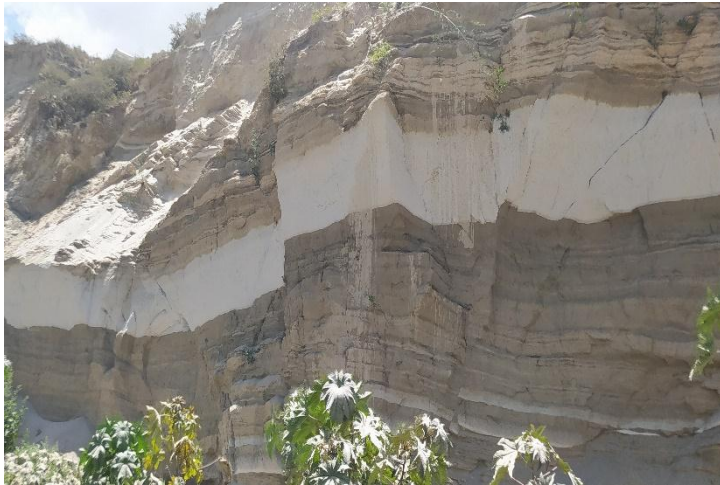
Foto No. 1: Inestabilidad de talud, margen izquierda de quebrada.
