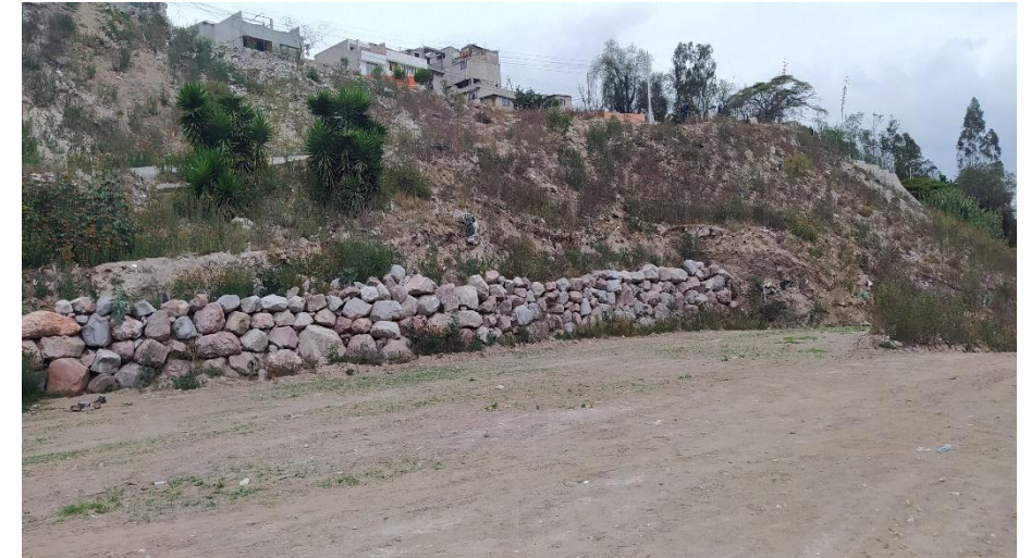
Foto No. 4: Relleno antitecnico en talud que colinda con calle Chaguar.
