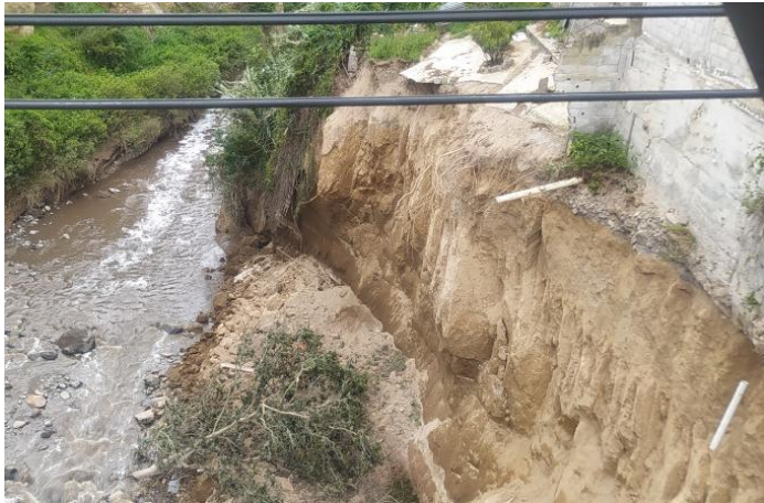
Foto No. 2 Inestabilidad de taludes, erosión hídrica, afectación a predios
