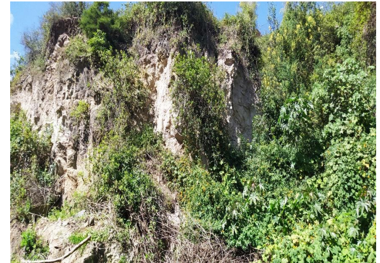
Foto No. 4: Arboles que generan inestabilidad talud debido a las raíces y podrían caer al cauce.
