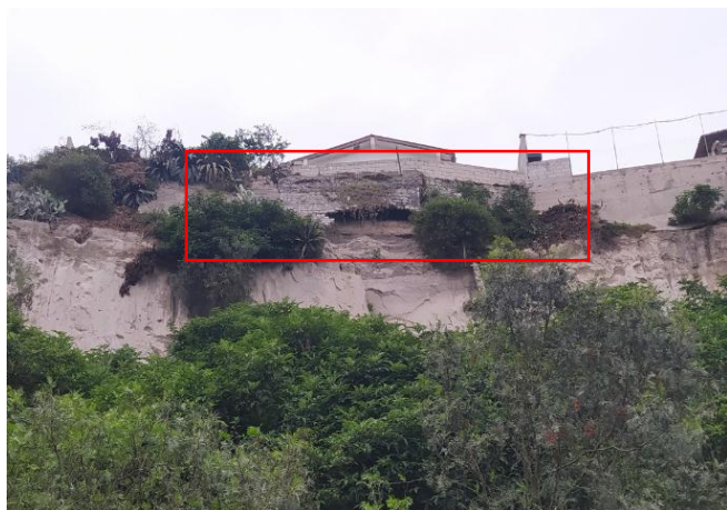
Foto No. 2 Muro sin base de cimentación.
