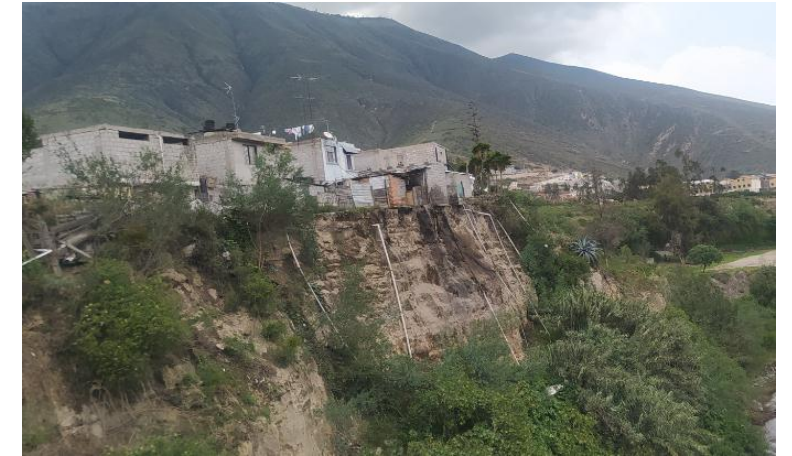
Foto No. 3: Viviendas en borde de talud superior y descargas informales.
