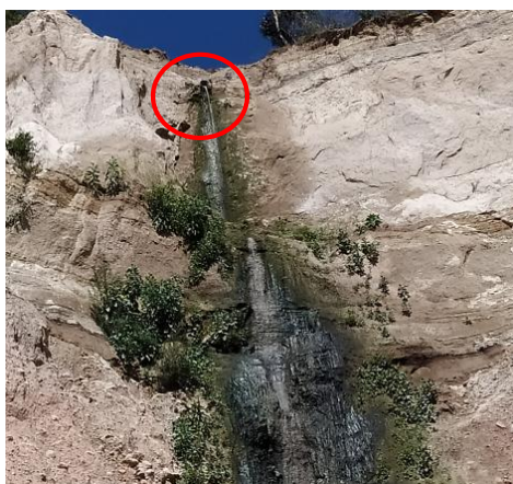
Foto No. 2 descargas informales al talud
