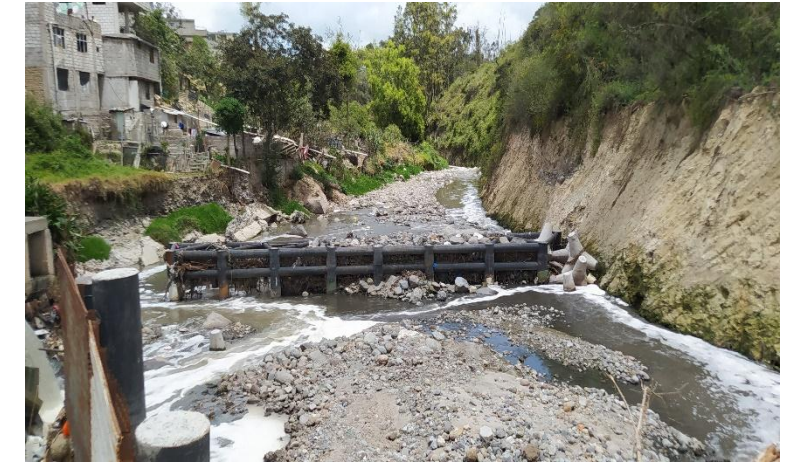
Foto No. 3: Estructuras hidráulicas EPMAPS azolvadas.
