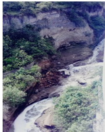
e. Proceso de erosión hídrica regresiva, bajo el talud.
