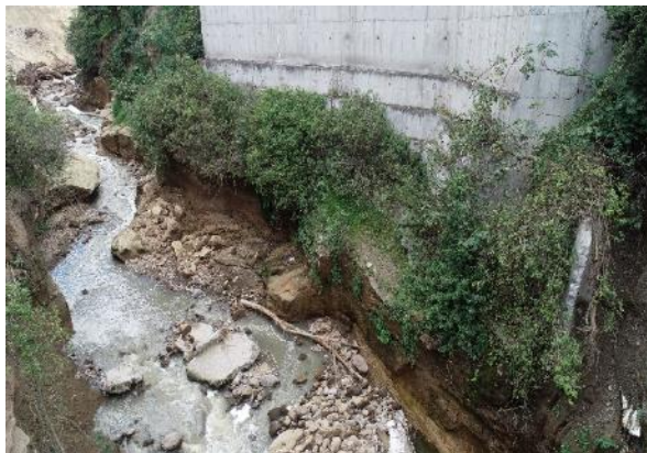
d. Socavamiento bajo las bases del muro
