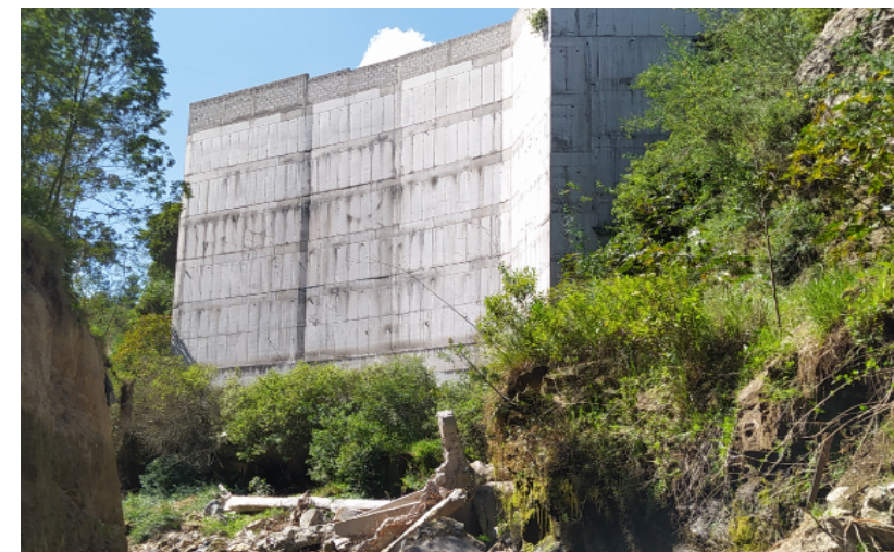
Reducir riesgo de posible volcamiento de muro Pfizer.
