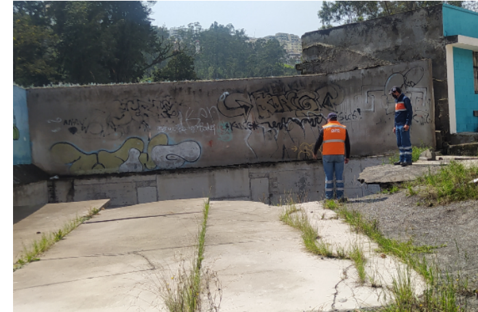
c. Pérdida del relleno en el trasdós del muro
