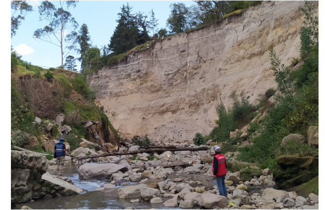
c. Taludes expuestos a erosión eólica e hídrica aguas abajo del deslizamiento en el 2021.
