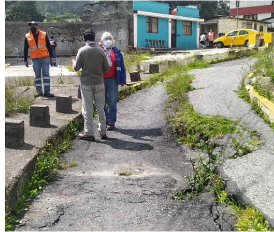
b. Asentamiento de la calle La Esperanza.
