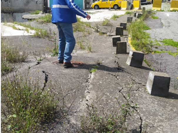
a. Agrietamiento en calle La Esperanza
