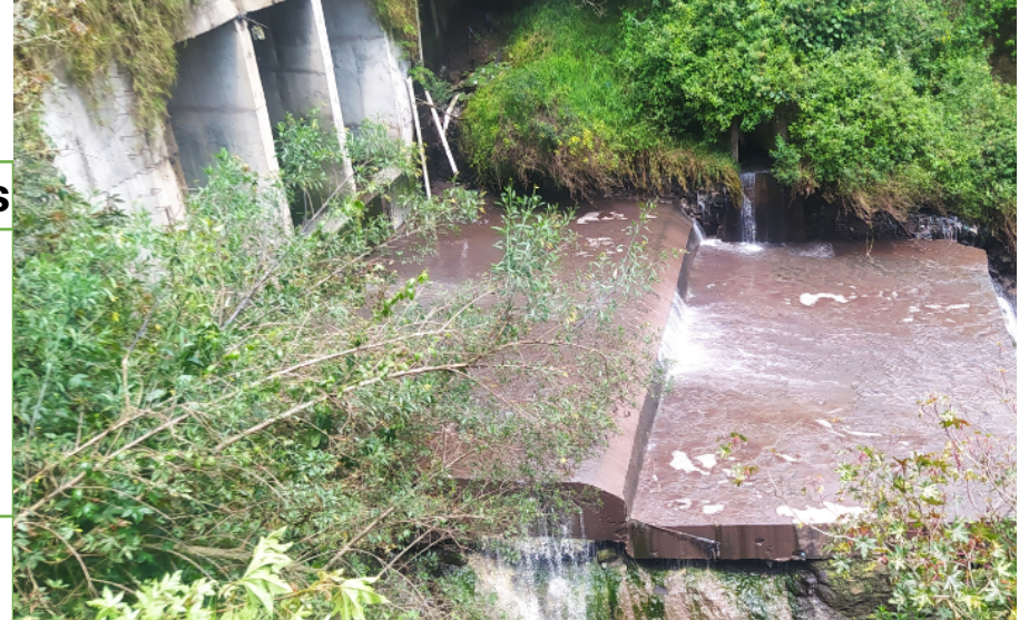
Ejecutar acciones paliativas URGENTES en la estructura hidráulica
