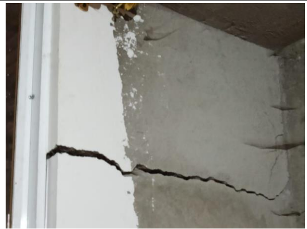
Fotografía No. 10: Interior de vivienda en predio 3502007. Se observa fisura en mampostería.
