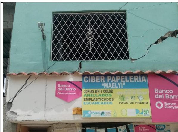
Fotografía No. 3: Fachada de vivienda de predio 3502008, se observa fisura en mampostería.
