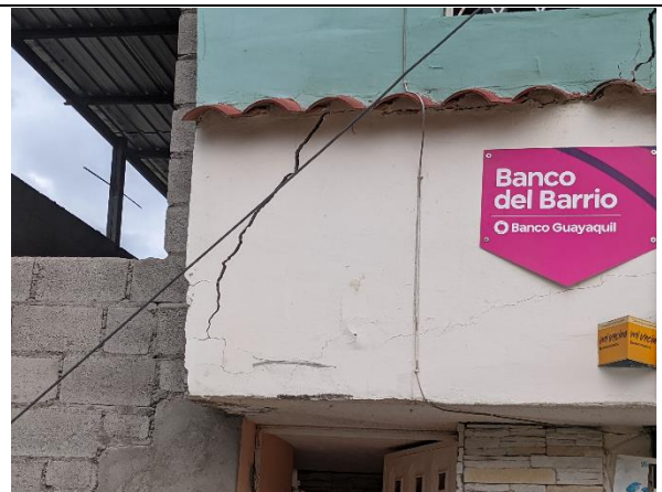
Fotografía No. 2: Fachada de vivienda de predio 3502008, se observa fisura en mampostería.
