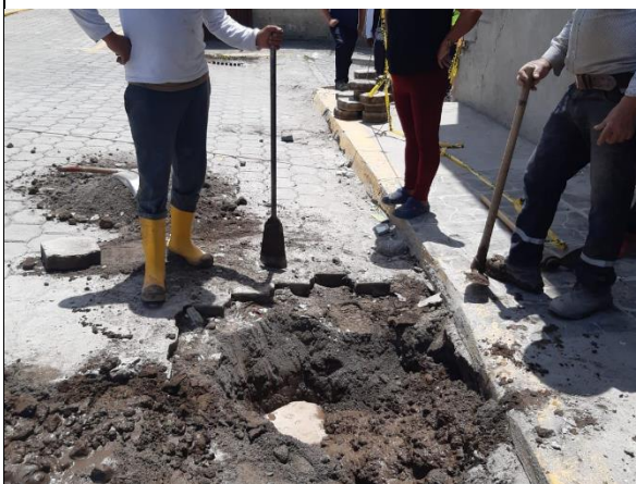
Fotografía No. 15: Excavación y fuga de agua, en el exterior del predio 3502007.
