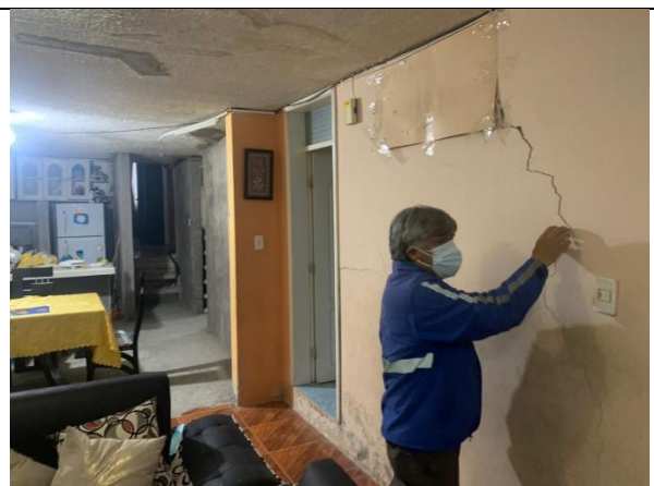
Fotografía No. 4: Interior de vivienda en predio 3502008. Se observa fisura en mampostería.
