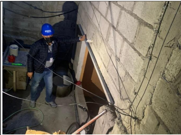
Fotografía No. 11: Interior de vivienda en predio 3502007. Se observa desplome en mampostería.
