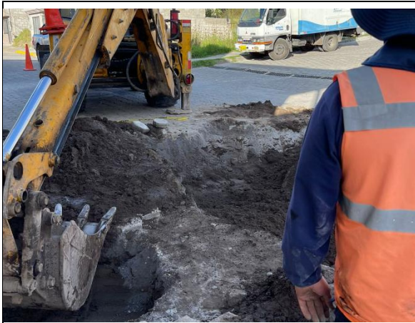
Fotografía No. 17: Excavación y fuga de agua, en el exterior del predio 3502007.
