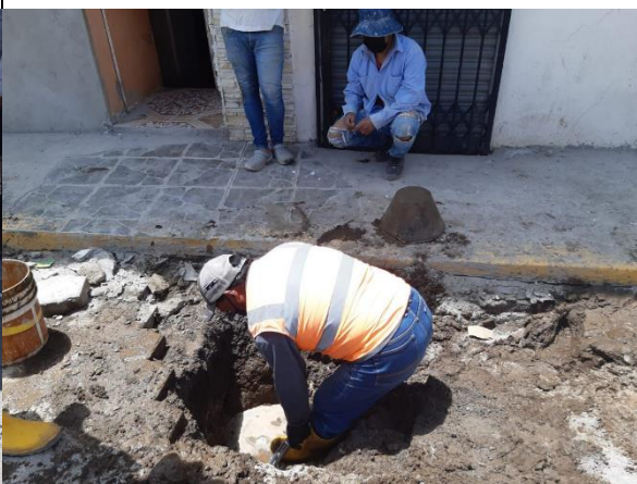
Fotografía No. 16: Excavación y fuga de agua, en el exterior del predio 3502007.
