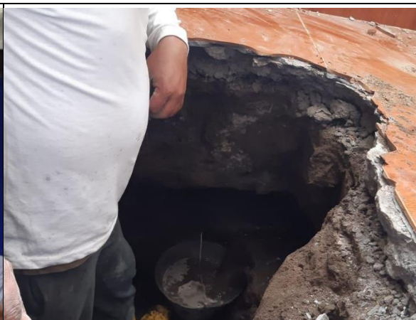
Fotografía No. 14: Interior de vivienda en predio 3502007. Se observa excavación y fuga de agua.
