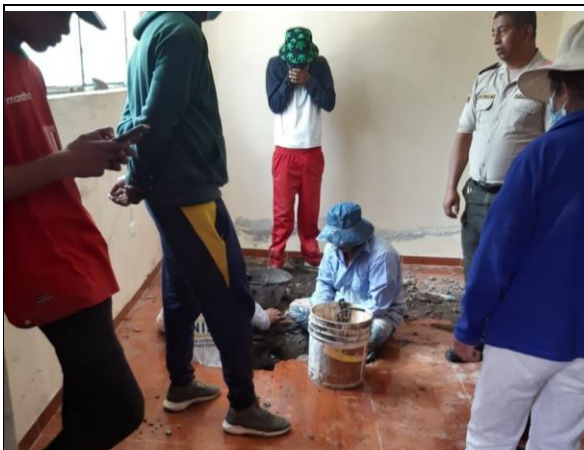
Fotografía No. 13: Interior de vivienda en predio 3502007. Se observa excavación y fuga de agua.
