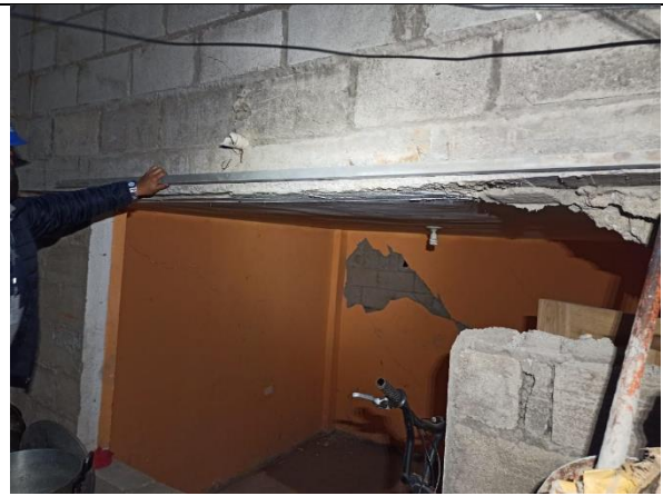
Fotografía No. 12: Interior de vivienda en predio 3502007. Se observa desplome en mampostería.
