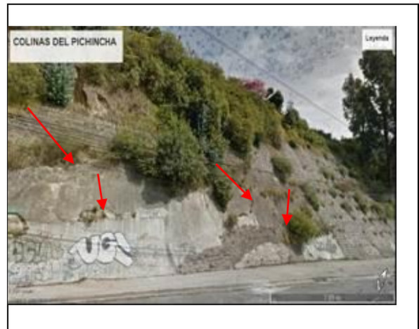
Foto No.4 En esta foto antes del evento se evidencia el calce efectuado con piedras y mortero, que fueron realizados luego del desprendimiento del talud .
