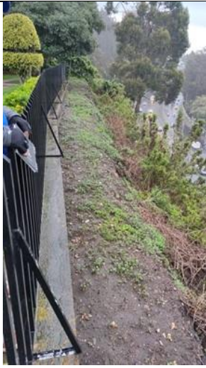
Foto No.11 El cerramiento posterior, del jardín se encuentra a menos de un metro del talud.
