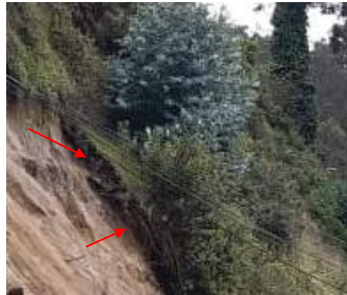
Foto No.8 Por la infiltración del agua, se produjo el lavado de finos y la mampostería de piedra quedó sin adherencia.
