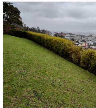
Foto No.10 Al no contar con un sistema de drenaje y cuneta revestida, las aguas lluvias fluyen directamente hacia el talud.
