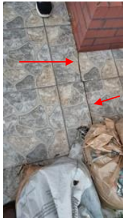
Foto No.13 En el piso de la PB2, se evidencia un ligero asentamiento, que ha provocado la rotura de la cerámica, que fue recientemente colocada.
