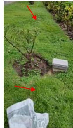
Foto No.14 Presencia de un ligero asentamiento, cubierto por la hierba, posibles fisuras de tracción.
