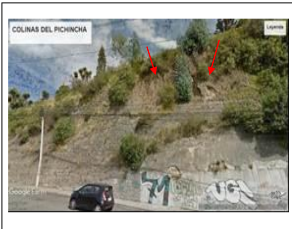
Foto No.3 En esta foto antes del evento se evidencia que se han formado líneas de agua (cárcavas) que fueron ingresando al calce efectuado con piedras y mortero.
