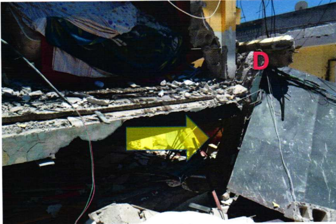
Fotografía 15: Columna D de la estructura afectada
