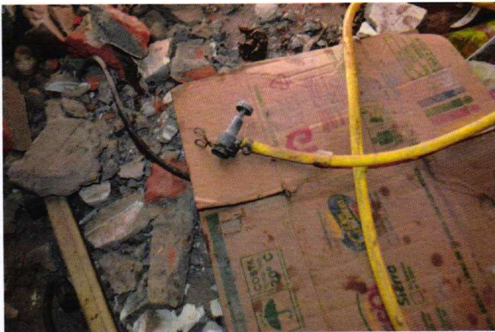
Fotografía 23: Manguera de gas conectada a una llave de paso.
