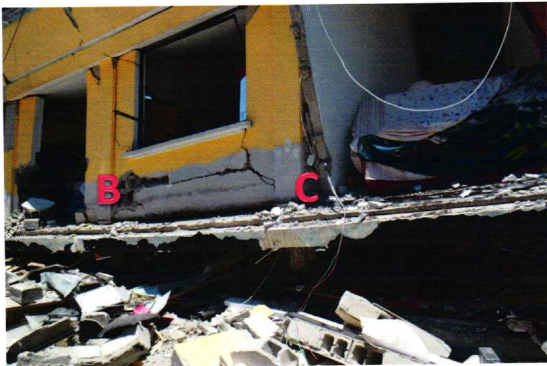
Fotografía 16: Columna B Y C desprendida completamente
