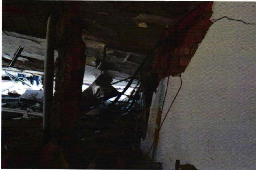
Fotografía 31: Pared lado este de cocina – no colapsada
