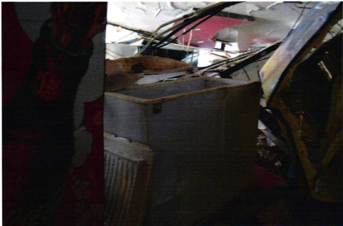
Fotografía 27: Congelador – Interior de cocina.
