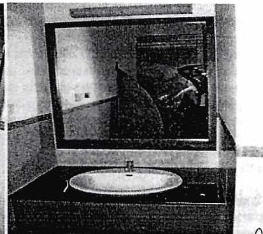
Vista 4- Baterías Sanitarias
