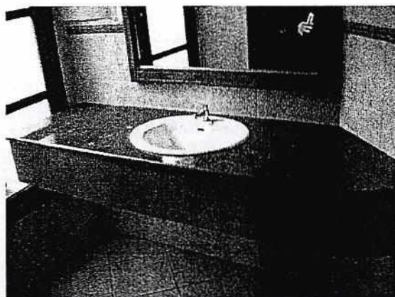
Vista 1- Baterías Sanitarias
