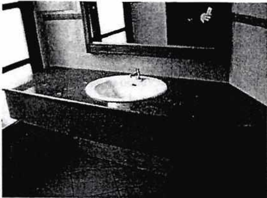
Vista 1- Baterías Sanitarias
