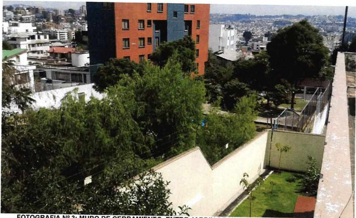
FOTOGRAFIA N° 3: MURO DE CERRAMIENTO, ENTRE JARDIN DE USO PRIVADO Y AREA COMUNAL
