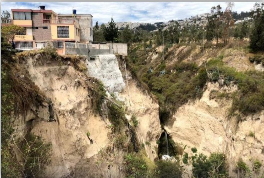
3. Erosión progresiva de cauces
