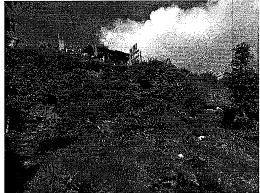
Talud con cobertura herbácea sin medidas de protección.
