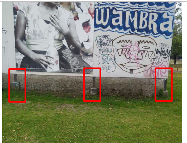
Fotografía 4. Corrosión de perfiles metálicos (columnas).
