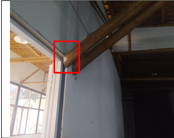
Fotografía 6. Caña guadua sin apoyo y con agrietamiento longitudinal.
