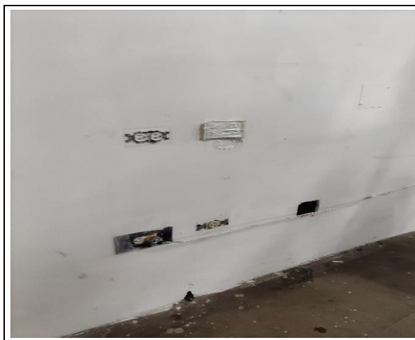
Fotografía No. 06 Tomacorrientes y cajetines eléctricos sin tapas
