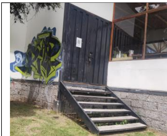
Fotografía No. 09 Gradas sin pasamanos lado norte.
