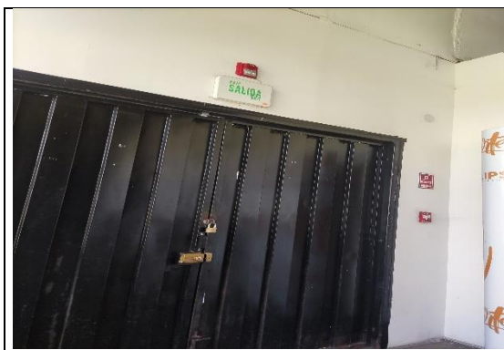
Fotografía No. 07 Sistema de alarma manual contra incendios
