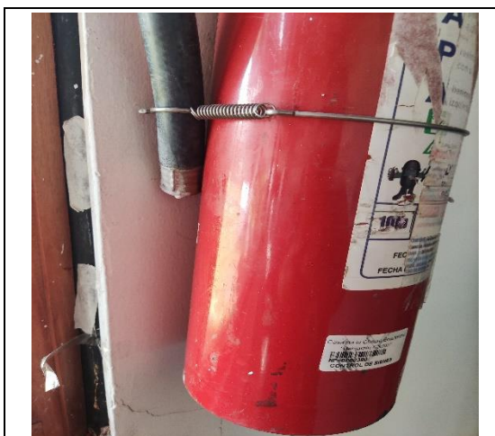
Fotografía No. 03 Extintor sin boquilla.
