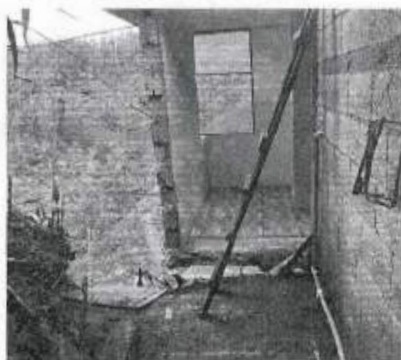
CASA DESALOJADA (EN PELIGRO DE COLAPSO)
