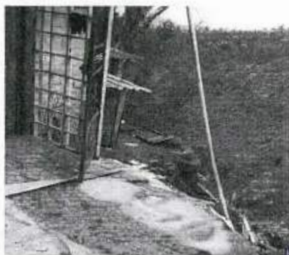
CASA ABANDONADA Y EN PELIGRO (TALUD INESTABLE)
