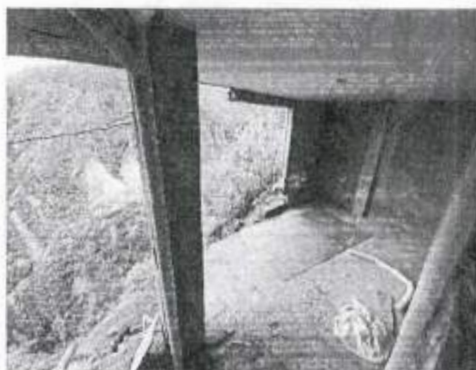
VIVIENDA DESHABITADA (LOCALIZADA A FILO DE TALUD)
