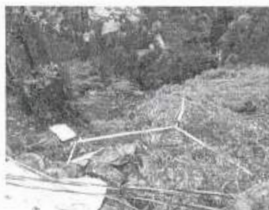
TUBERIAS PARA DESCARGA DE AGUAS
