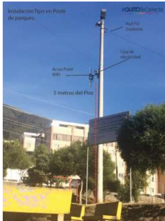
Ejemplo de cómo se realizó la Instalación de puntos en Poste de luz en Parque Altamira.
