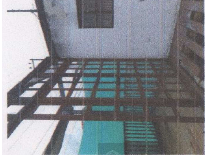
AFECCIÓN ESTRUCTURA DE MADERA
