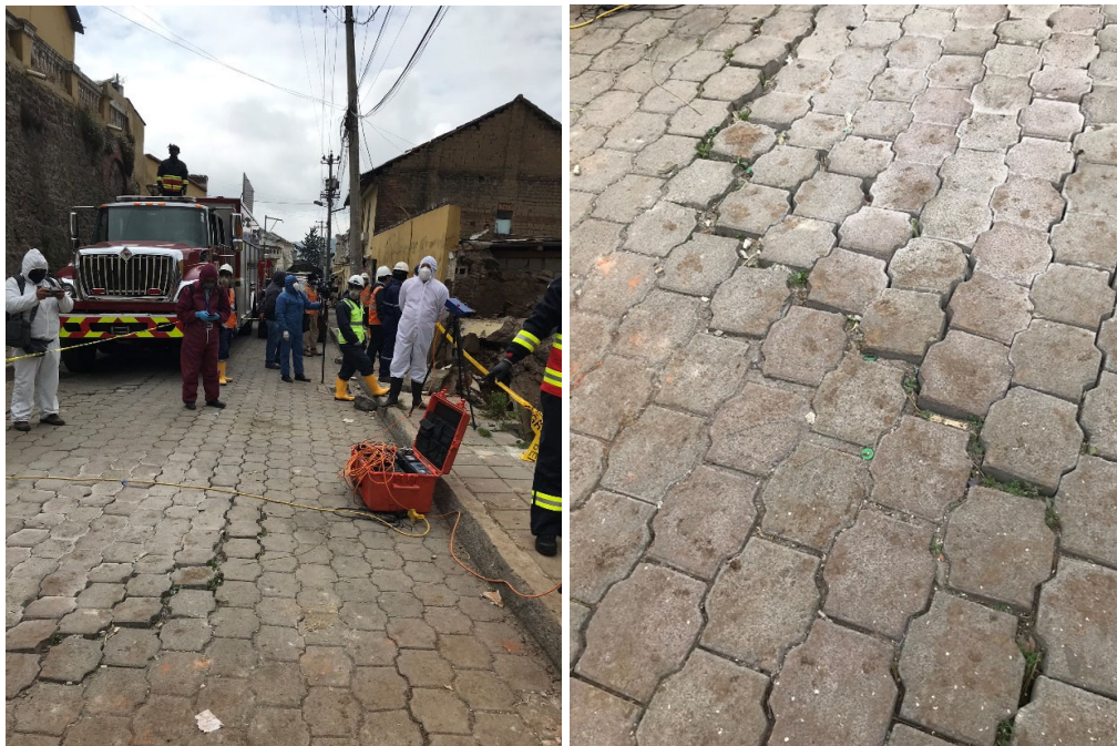
FOTOGRAFIA N 7-8: ASENTAMIENTO DIFERENCIAL Y MOVIMIENTO DE ADOQUINES
