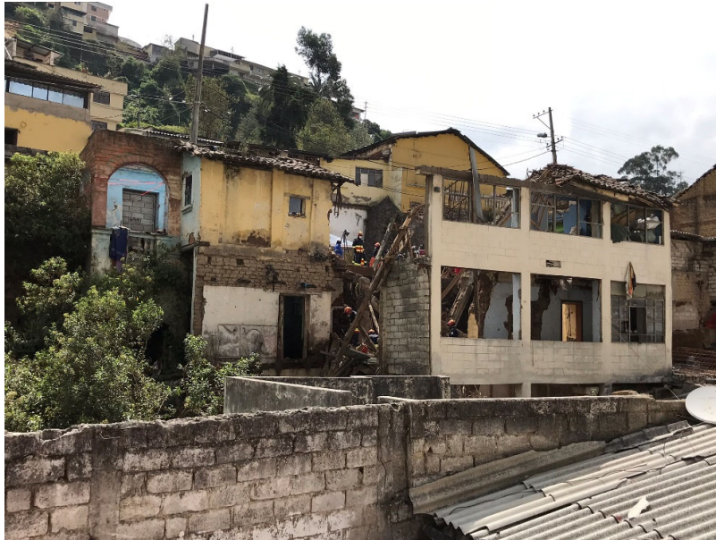
FOTOGRAFIA N 11: COLAPSO POR IMPLOSION DEL INMUEBLE
