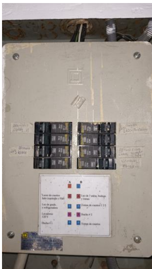
Imagen N°5: Tablero en Local comercial de la planta alta 2
