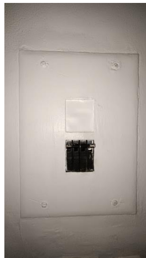
Imagen N°6: Tablero en Local comercial de la planta alta 1
