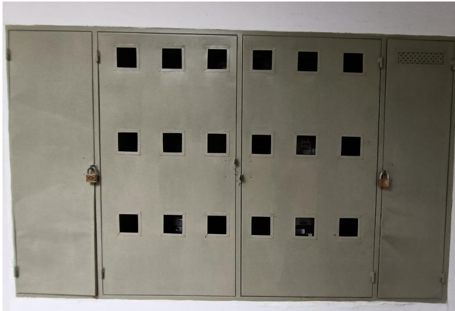
Imagen N°1: Tablero de distribución principal y medidores de energía
