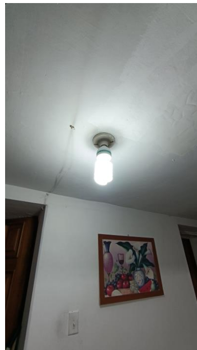
Imagen N°8: iluminación con lámparas compactas fluorescentes autobalastadas (focos ahorradores).
