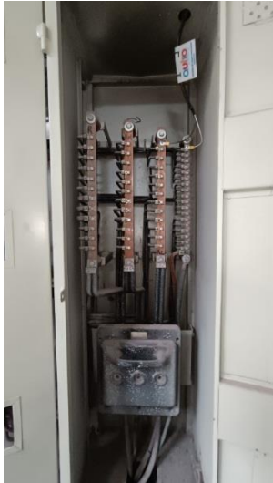
Imagen N°3: Acometida y barras de energía
