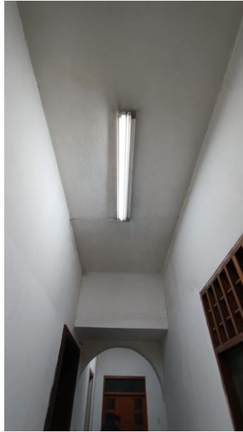
Imagen N°9: Iluminación con Lámparas fluorescentes compactas
