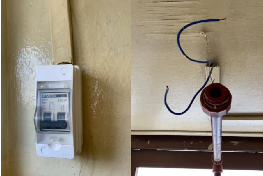
Imagen N°13: Salida especial para ducha eléctrica
