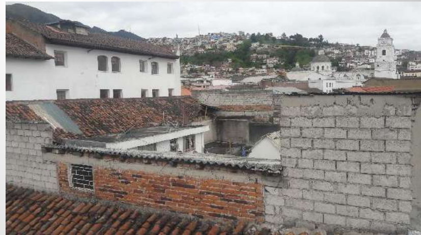
TEJA-ZINC Y FICROCEMENTO DETRIORADO
