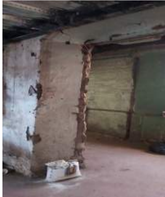
PATOLOGIA DESPRENDIMIENTO DE ENLUCIDO.
