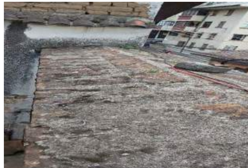
PATOLOGIA, DETERIORO DE REVOCADO EN UNIONES DE LADRILLO,.
