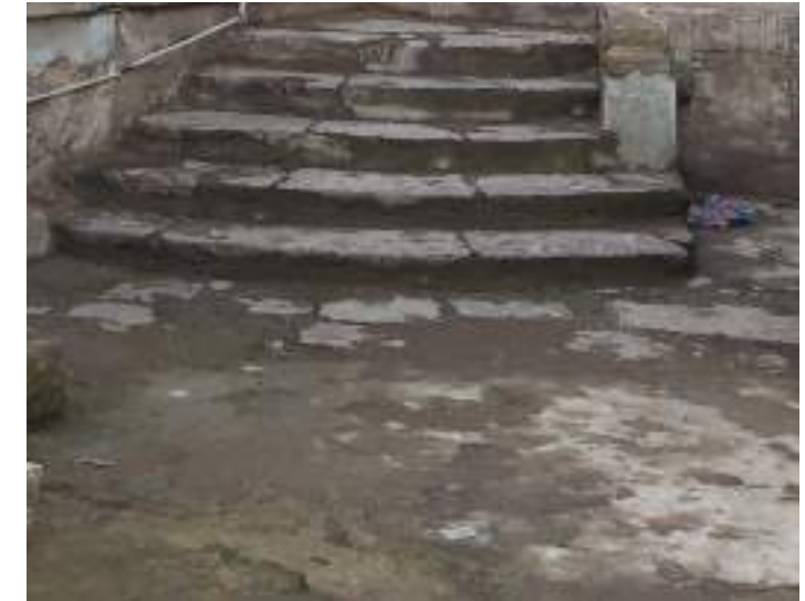
PATOLOGIA, DETERIORO PISO DE PATIO PRINCIPAL, ZOCALO PERIMETRAL DE PATIO
