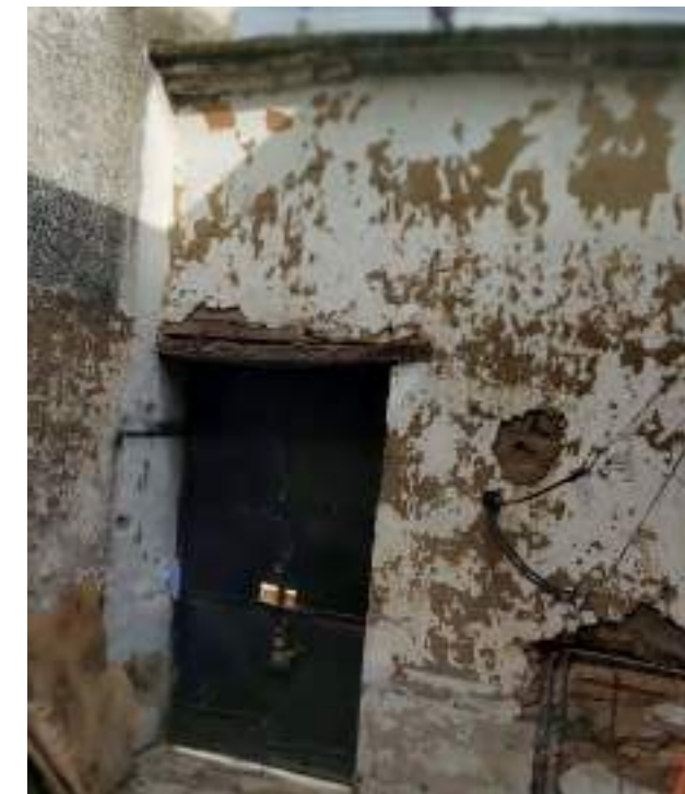
PATOLOGIA, Deterioro de enlucido en muro de ingreso al igual en dintel de madera.
