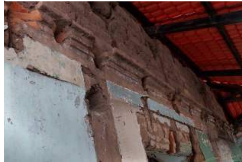
PATOLOGIA, DESPRENDIMIENTO DE ENLUCIDO, DETERIORO DE MORISCO, DETERIORO DE MAMPOSTERIA, LOCALIZADO EN SEGUNDA PLANTA ALTA.
