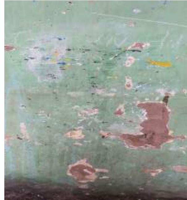
PATOLOGIA DESPRENDIMIENTO EN PARTE TANTO DE ENLUCIDO COMO DE PINTURA.
