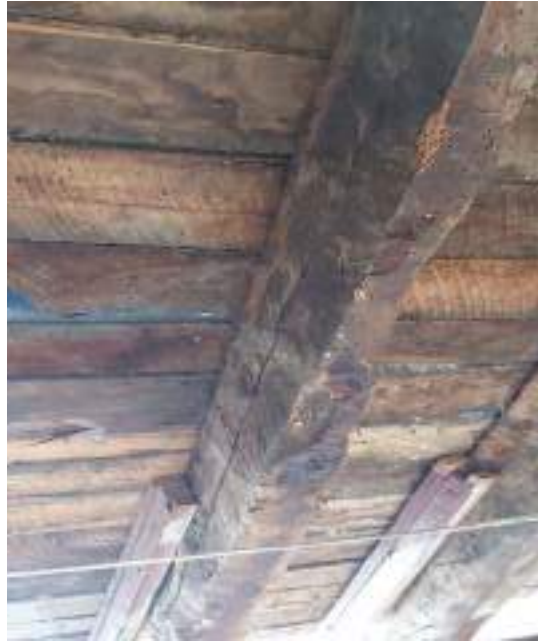
PATOLOGIA, POLILLA DETERIORO EN PISOS Y ENTABLADO EN ENTREPISO
