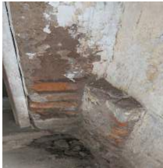
DESPRENDIMIENTO DE ENLUCIDO EN PARED DE BAÑO PRIMERA PLANTA ALTA
