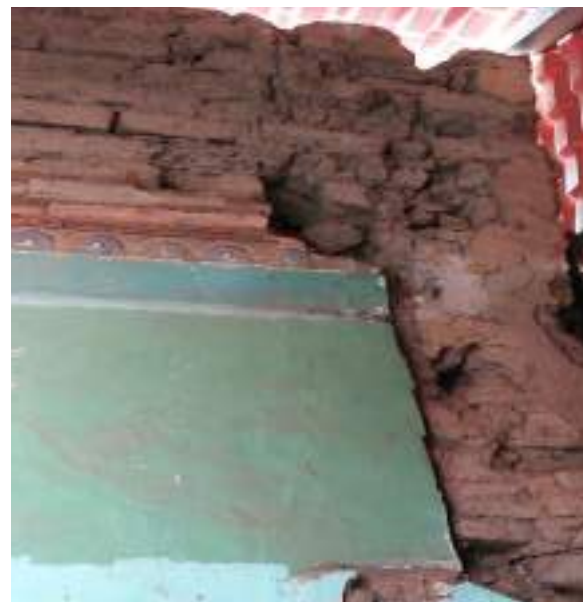
PATOLOGIA DETERIORO DE MAMPOSTERIA DE ADOBE AL IGUAL QUE LA CORNIZA.
