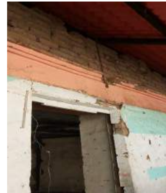
5PATOLOGIA DESPRENDIMIENTOS DE ENLUCIDO CORNISA MOLDURA EN VANO DE PUERTA.
