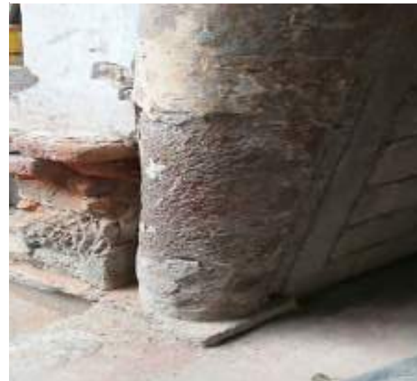
PATOLOGIA EN PIEDRA, DETERIORO EN FUSTE Y BASE.
