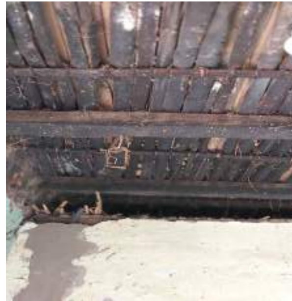
ESTRUCTURA DEL TUMBADO ORIGINAL, compuesto por madera chancada dispuesta en forma transversal alas pisos de madera y sujetadas con soguilla de cabuya, con una tecnica mas bien vernacula.
