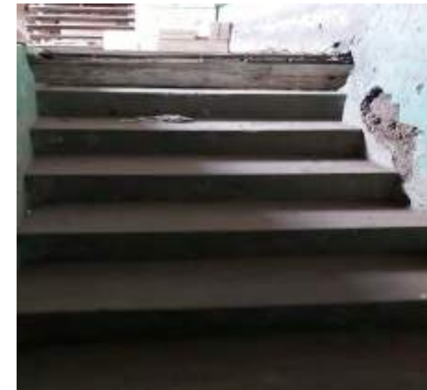
PATOLOGIA, Desprendimiento de enlucido en pared, tratamiento de superficie de grada.
