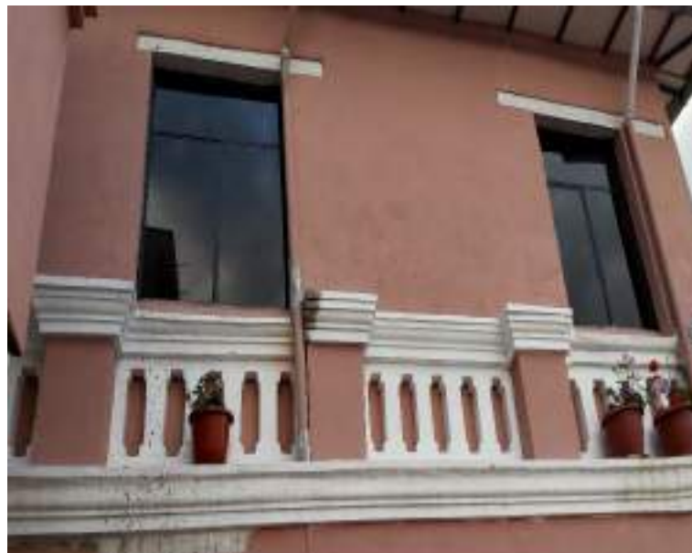
4DETALLES ARQUITECTONICOS EN FACHADA LATERAL DERECHA FRISO CON MOLDURAS Y CORNISA, DINTEL TRADICIONAL DE MADERA EN VENTANAS
