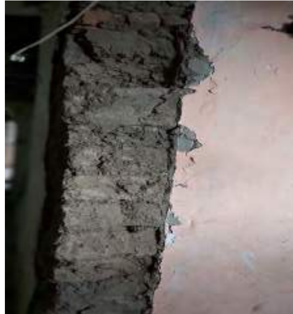
PATOLOGIA, En esta pared se localiza desprendimiento del enlucido, así como deterioro de algunos adobes.
