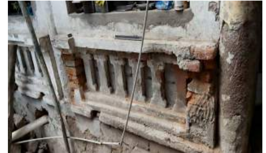
PATOLOGIA EN FRISO, Desprendimiento del revestimiento, deterioro de la mampostería de ladrillo.
