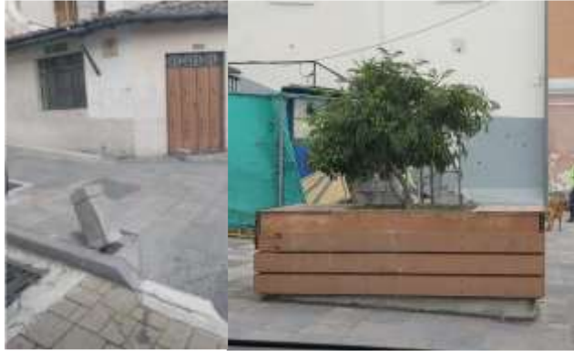
Imagen 3. Elementos Urbanos deteriorados. Fuente: Memoria Técnica, 2022.
