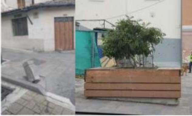
Imagen 3. Elementos Urbanos deteriorados. Fuente: Memoria Técnica, 2022.
