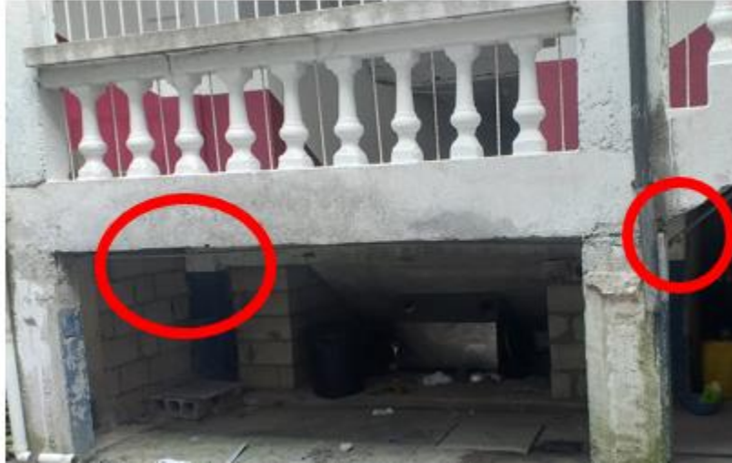
Fotografía 6. Columna corta eje D3 y C3.
