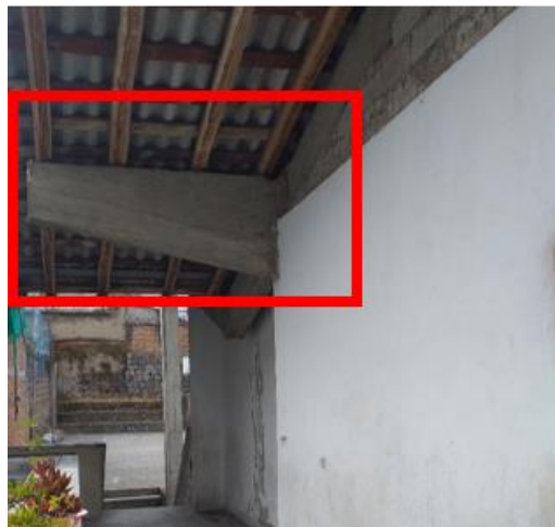
Fotografía 11. Columna débil - viga fuerte eje 8 cubierta.
