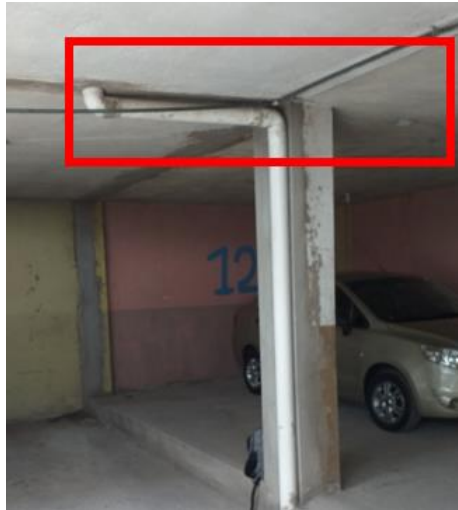
Fotografía 10. Nudo débil columna B8.
