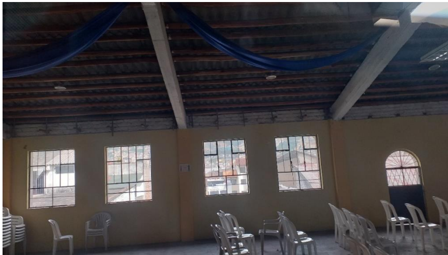
Fotografía 9. Deficiencia de columnas segunda planta.
