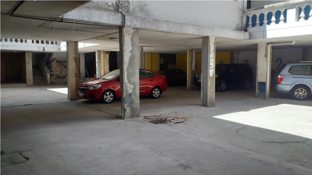
Fotografía 7. Piso blando en la planta baja.
