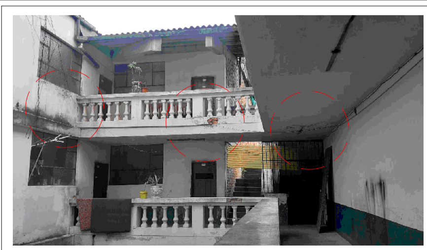
03 Humedades por filtraciones
