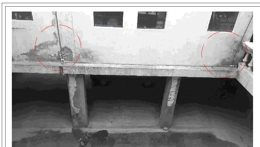
01 Desprendimiento de pintura
