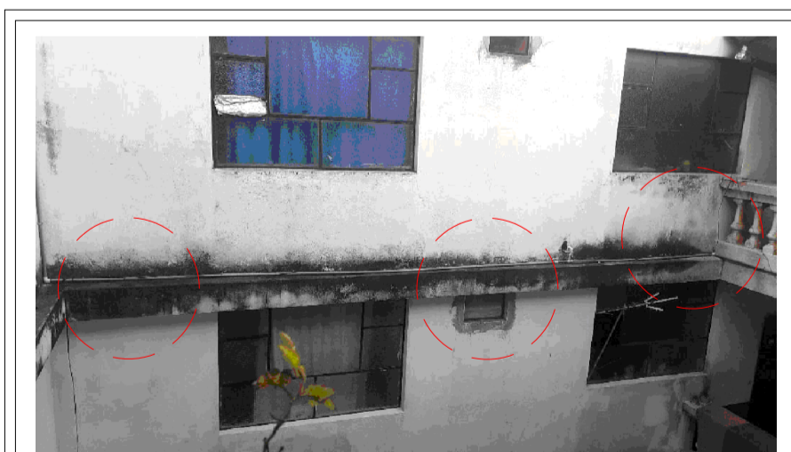
03 Humedades por filtraciones
