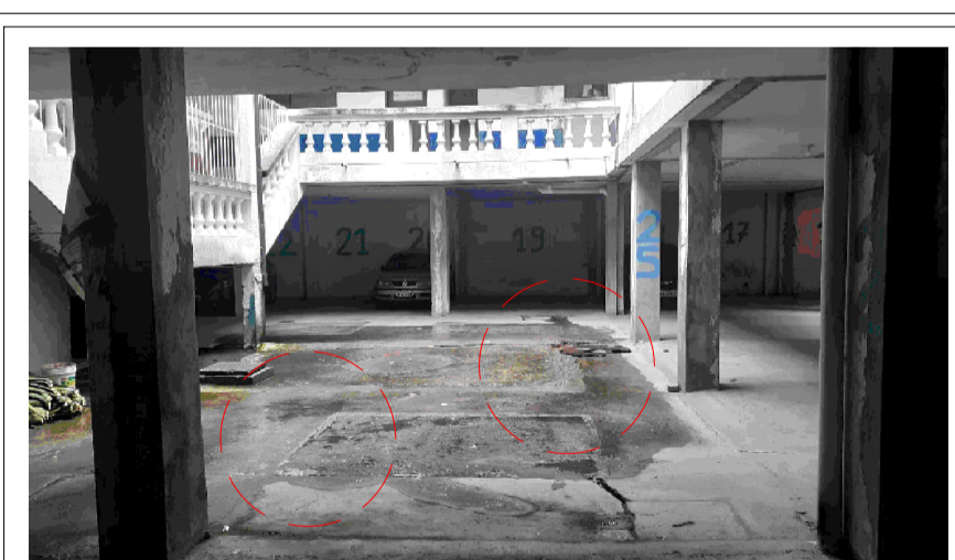
02 Desprendimiento del piso masillado.
