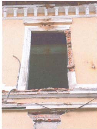
Ilustración 17 Pérdida de molduras
