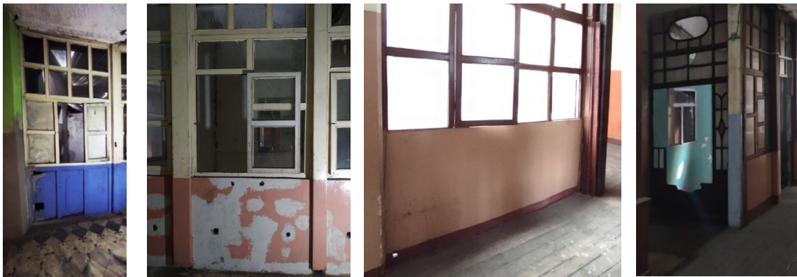
Figura 41: Carpinterías interiores: pasillos y divisiones precarias.
