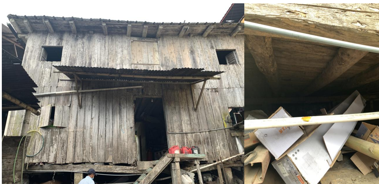
Vista de Fachada Posterior y detalle de vigas apollilladas de inmueble con predio 780501
