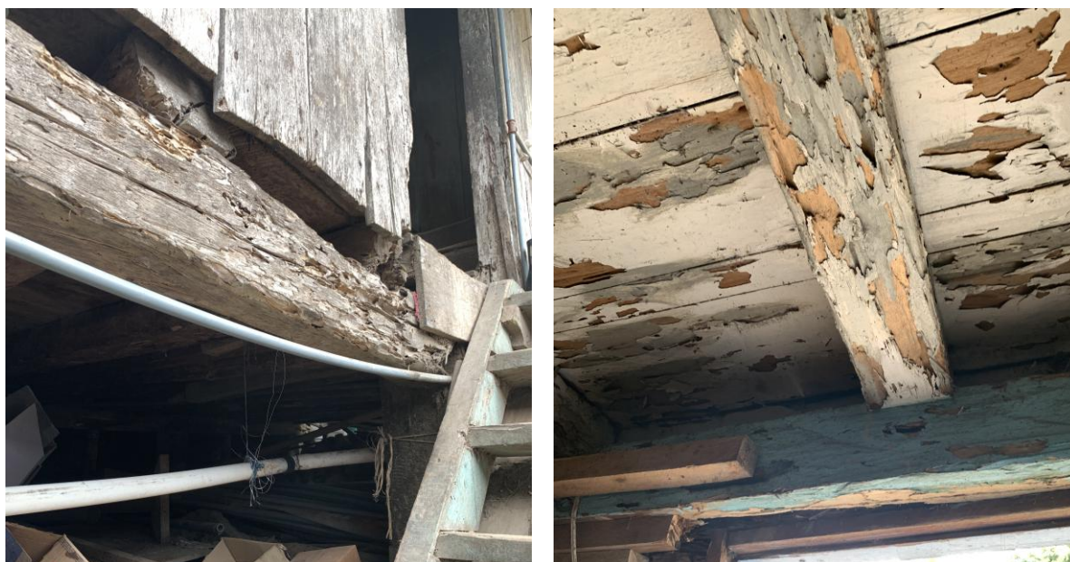
Detalle de vigas apollilladas de inmueble con predio 780501
